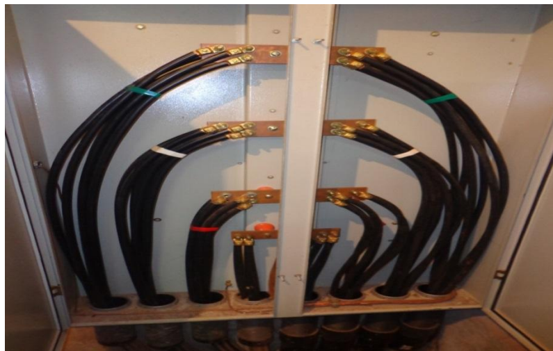
Figura 31 - Quadro de conexão da entrada de BT (TR 1) - visão interna Fonte: Autoria própria.
