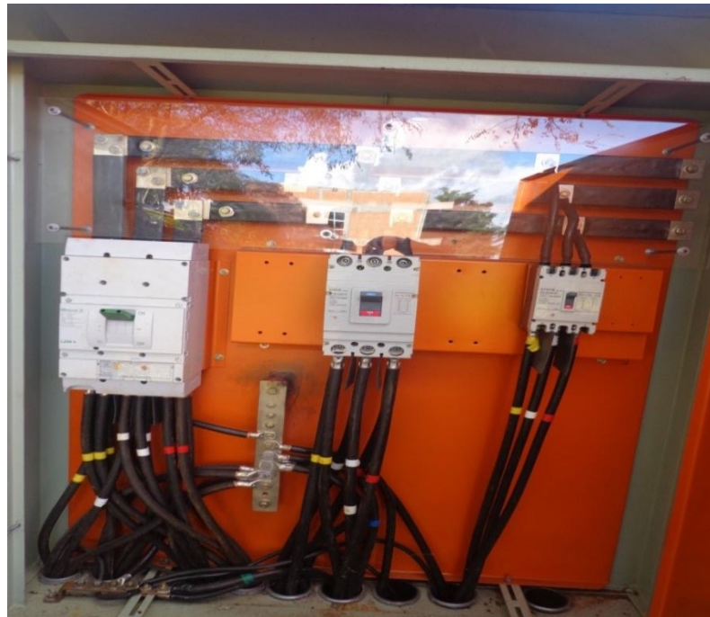
Figura 60 - Quadro de Geral de BT (TR 4) – visão interna Fonte: Autoria própria.
