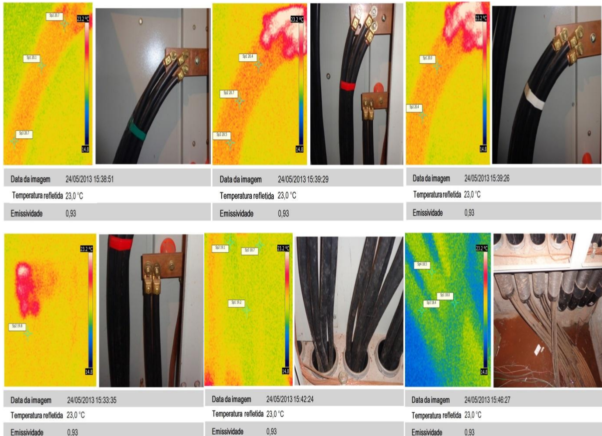
Figura 32 - Quadro de conexão da entrada de BT (TR 1) - cabos Fonte: Autoria própria
