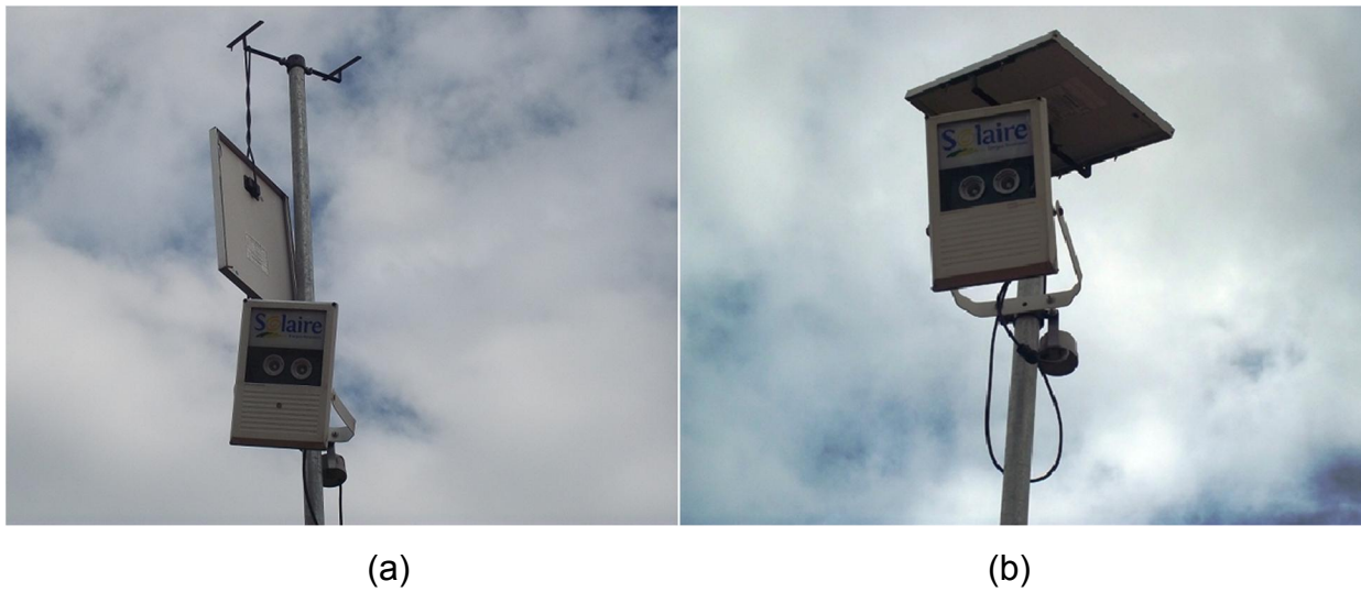
Figura 3 – Luminária Do Sistema De Iluminação Atual. Fonte: Autoria Própria.
