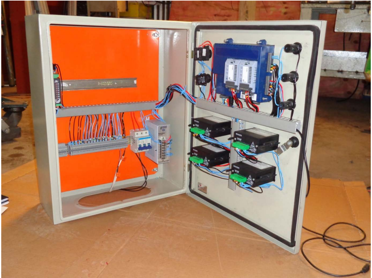
Figura 28: Vista interna do painel. Fonte: Autoria Própria
