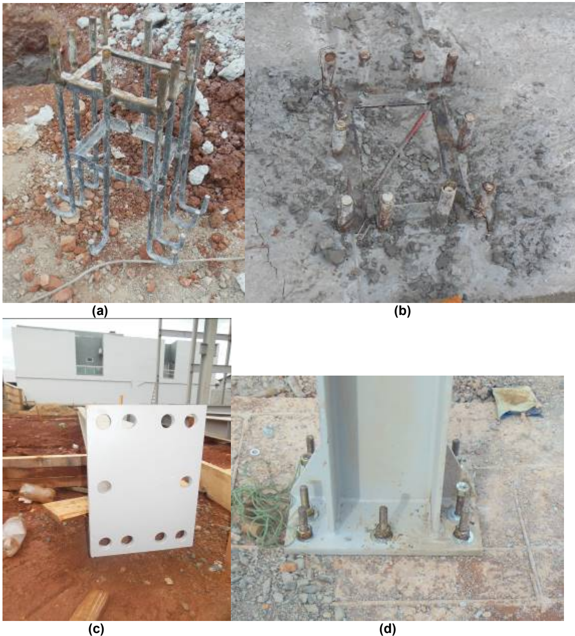
Figura 81: (a)Chumbador de ligação pilar com fundação, (b)Chumbador fixado no bloco de fundação, (c)Placa de ligação entre pilar e fundação, (d)Ligação pilar com fundação. Fonte: AUTOR (2015).
