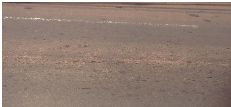
Figura 25 – Fissura longitudinal de baixa severidade na seção 10 Fonte: Autoria própria.
