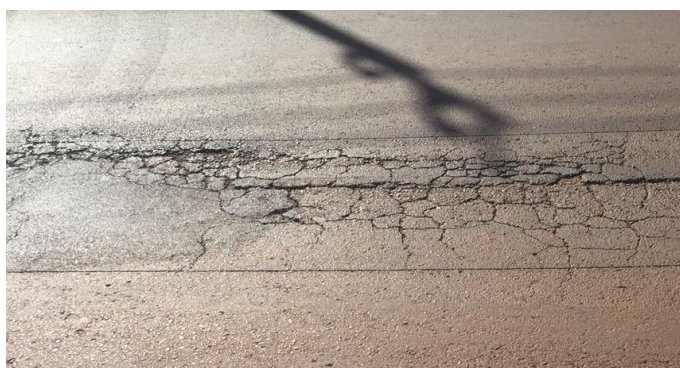
Figura 28 – Trincas longitudinais de alta severidade na seção 13 Fonte: Autoria própria.
