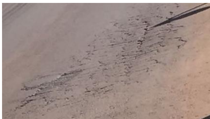
Figura 27 – Fissura longitudinal de alta severidade na seção 12 Fonte: Autoria própria.
