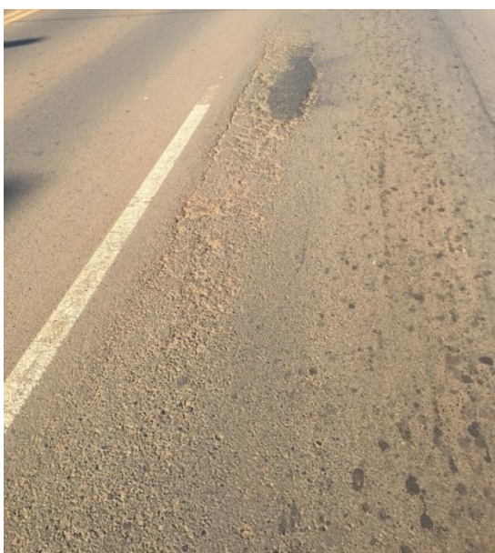
Figura 14 – Afundamento localizado de severidade média na seção 3 Fonte: Autoria própria.
