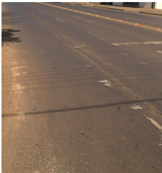
Figura 26 – Exsudação de baixa severidade na seção 11 Fonte: Autoria própria.
