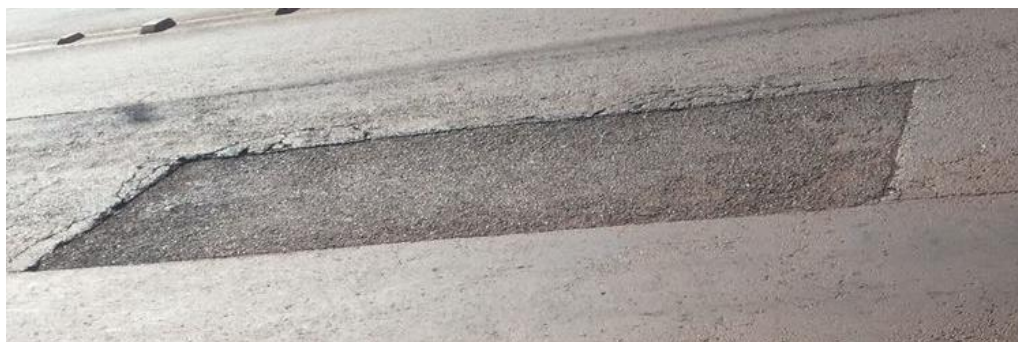
Figura 23 – Remendo média severidade na seção 9 Fonte: Autoria própria.
