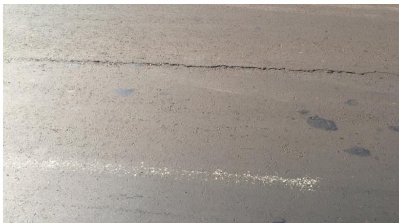
Figura 21 – Fissura longitudinal baixa severidade na seção 7 Fonte: Autoria própria.
