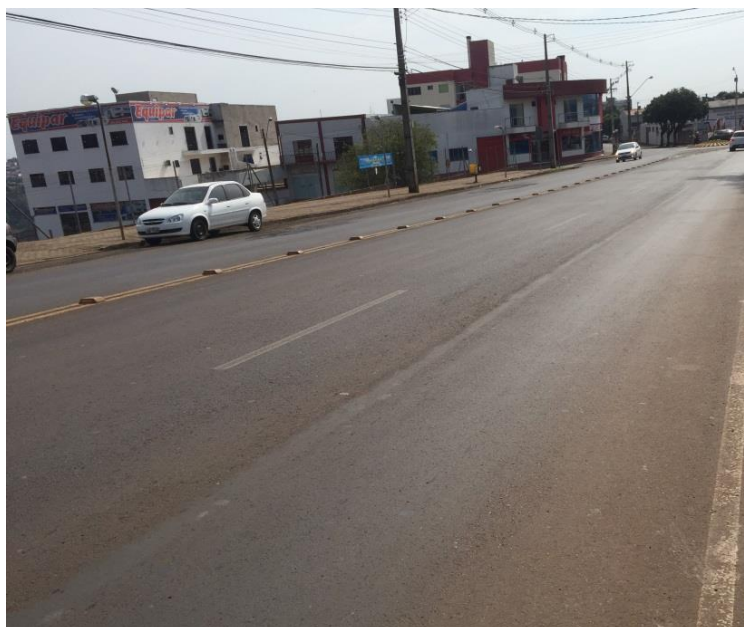
Figura 12 – Desgaste baixa severidade na seção 2 Fonte: Autoria própria.
