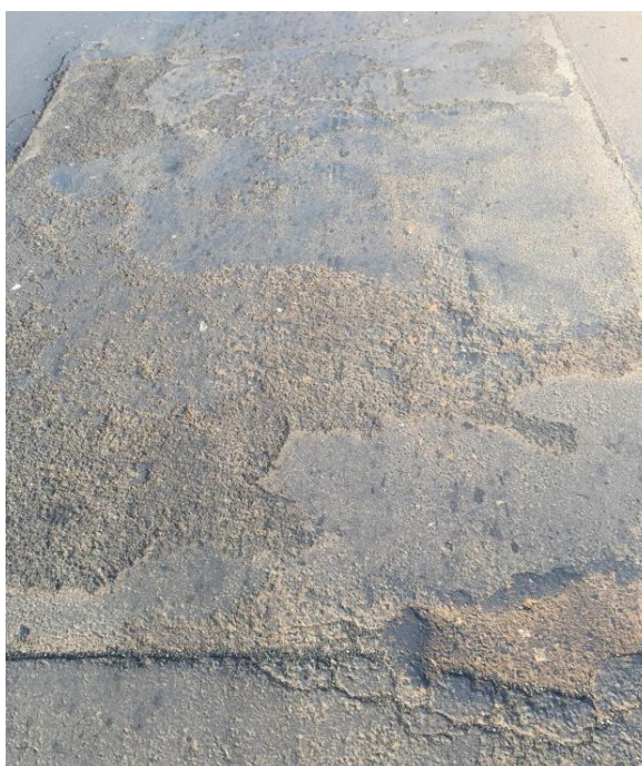
Figura 11 – Remendo severidade média na seção 1 Fonte: Autoria própria.
