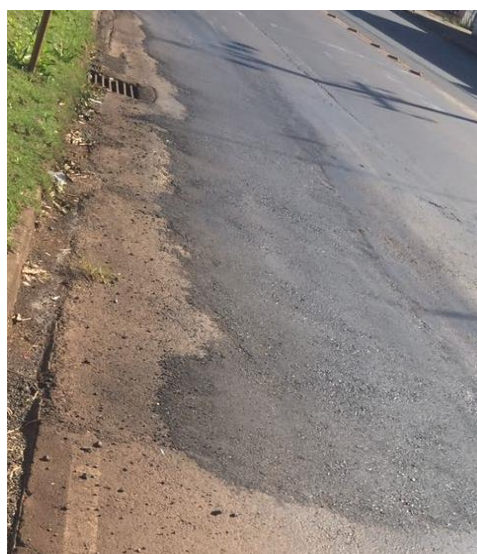
Figura 30 – Escorregamento de massa de alta severidade na seção 14 Fonte: Autoria própria.
