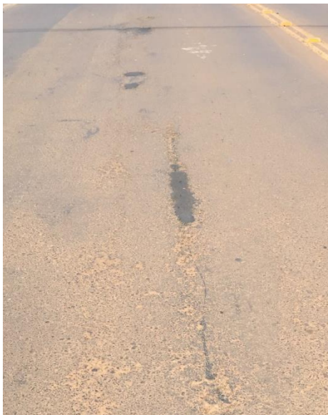
Figura 22 – Fissura longitudinal baixa severidade na seção 8 Fonte: Autoria própria.
