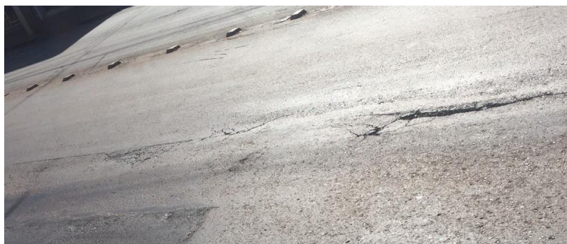
Figura 29 – Trincas longitudinais de baixa e alta severidades na seção 14 Fonte: Autoria própria.
