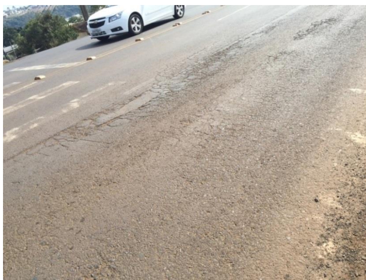
Figura 17 – Fissuras longitudinais de alta severidade na seção 4 Fonte: Autoria própria.
