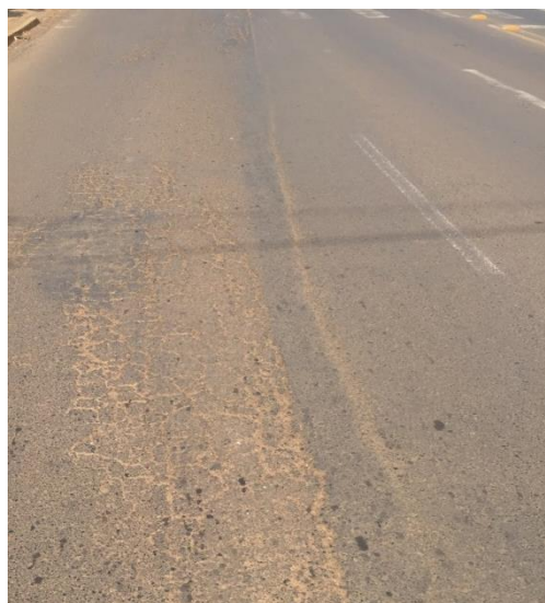
Figura 20 – Fissura longitudinal média severidade na seção 6 Fonte: Autoria própria.
