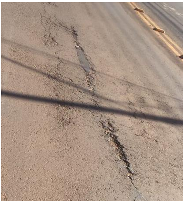
Figura 16 – Fissuras longitudinais de média severidade na seção 4 Fonte: Autoria própria.
