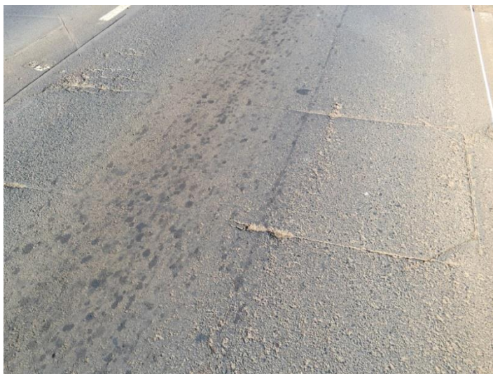
Figura 15 – Desgaste de severidade média no trecho 3 Fonte: Autoria própria.
