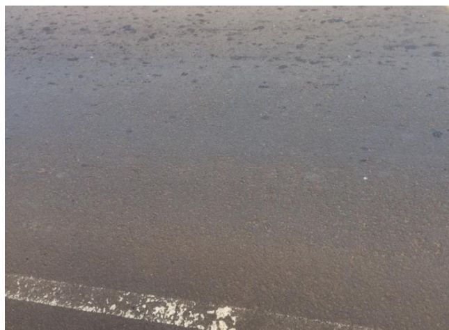
Figura 13 – Desgaste de severidade média na seção 3 Fonte: Autoria própria.
