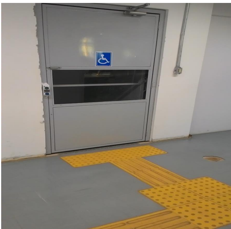
Figura 66 - Plataforma elevatória vertical sem sinalização dos pavimentos Fonte: Acervo do autor (2016).
