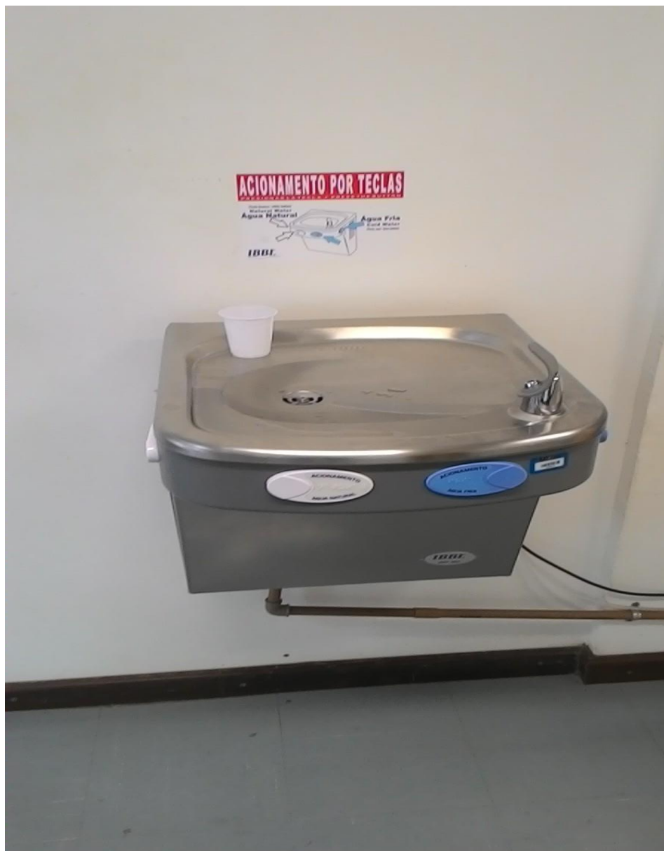
Figura 64 - Bebedouro do bloco W Fonte: Acervo do autor (2016).
