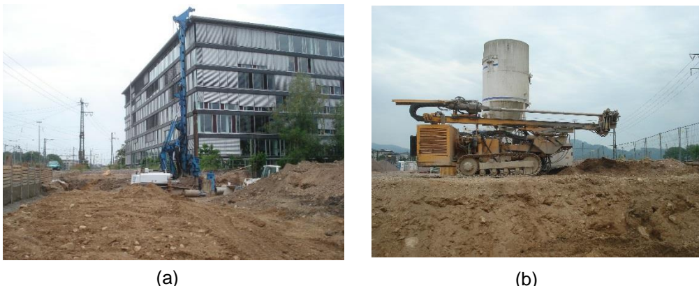
Figura 10: (a) Escavação de fundação profunda –Prédio Comercial, (b) Máquina de escavação de fundação profunda – Prédio Comercial Fonte: Arquivos internos Züblin (2012)
