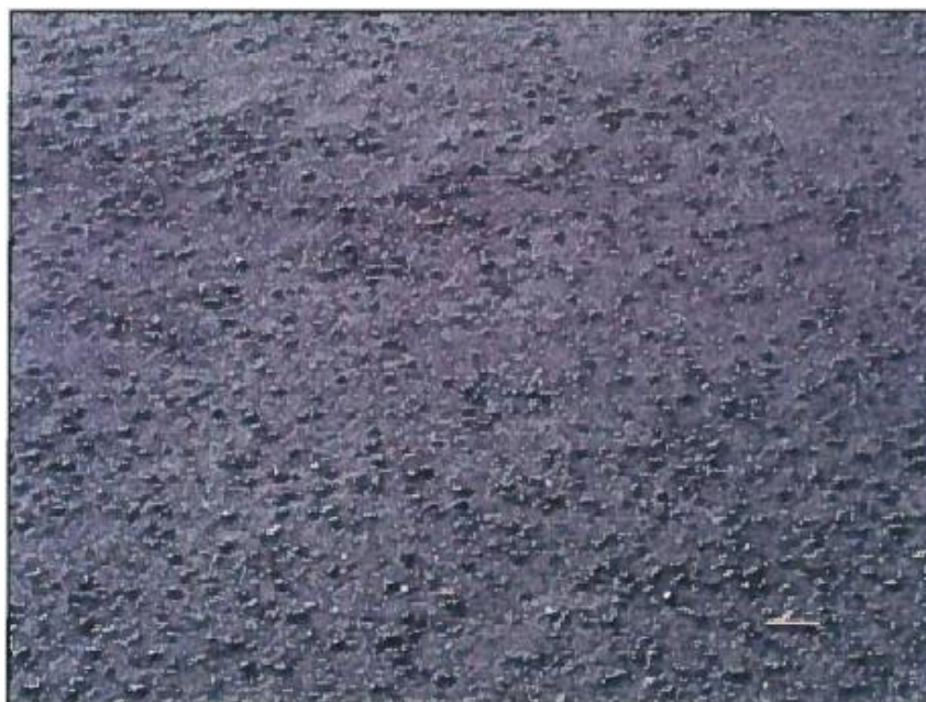
Figura 1 - Leito Asfáltico com defeito - características de desgaste FONTE: Bernucci et al (2008 apud BUCCHARLES, 2014, p.62).
