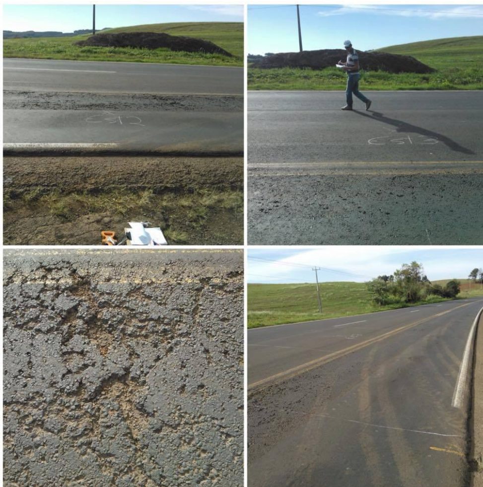
Figura 37 – Qualidade do Pavimento pelo Método do IGG FONTE: Autoria Própria (2015)
