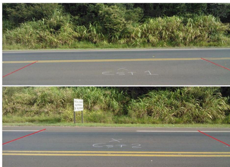
Figura 26 – Exemplo de demarcação de áreas para inventário de defeitos FONTE: Autoria Própria (2015)
