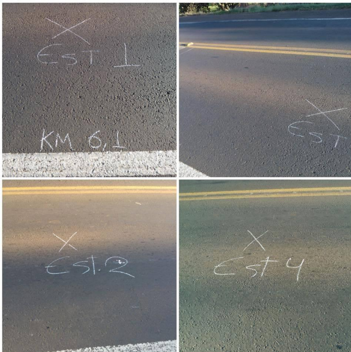
Figura 38 – Qualidade do Pavimento pelo Método do IGG FONTE: Autoria Própria (2015)
