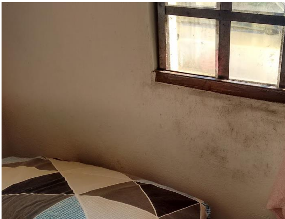
Figura 14 - Mofo apresentado na habitação do estudo de caso Fonte: Acervo do autor
