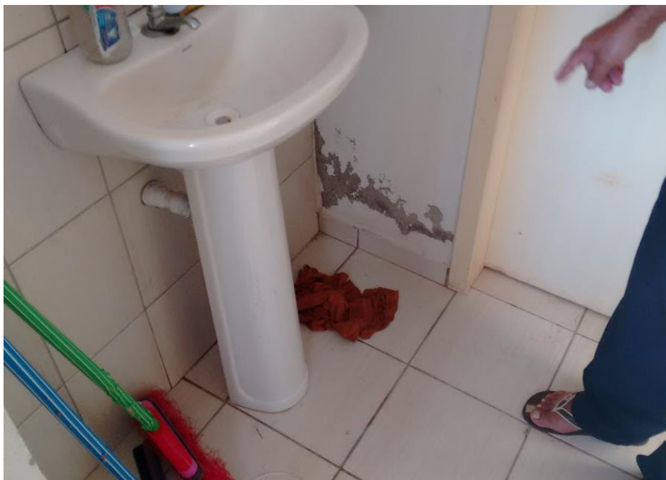
Figura 18 - Patologia no acabamento da parede do banheiro observada no estudo de caso Fonte: Acervo do Autor.
