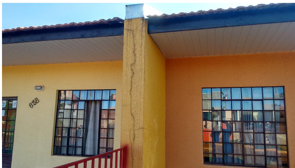
Figura 9 - Patologia observada no estudo de caso Fonte: Acervo do Autor.
