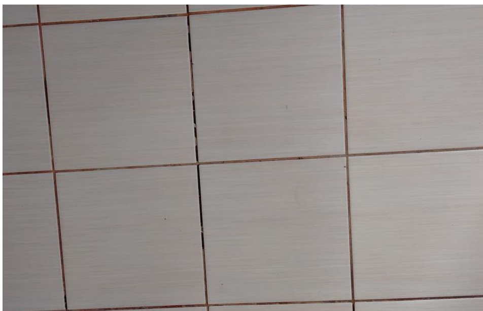
Figura 17 - Descolamento do piso observado no estudo de caso Fonte: Acervo do Autor
