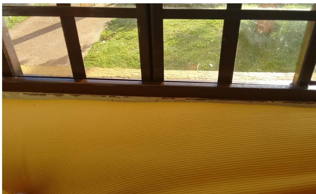
Figura 16 - Esquadrias mal instaladas, acabamento falho observados no estudo de caso Fonte: Acervo do autor
