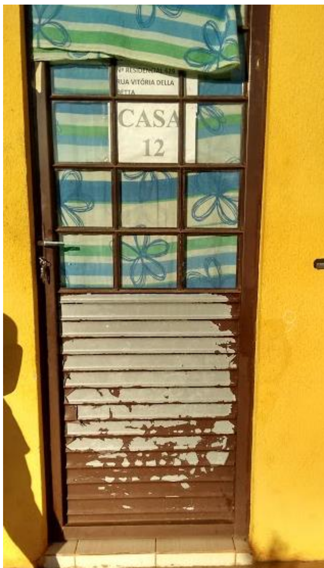
Figura 13 - Patologia na pintura presente no estudo de caso Fonte: Acervo do Autor
