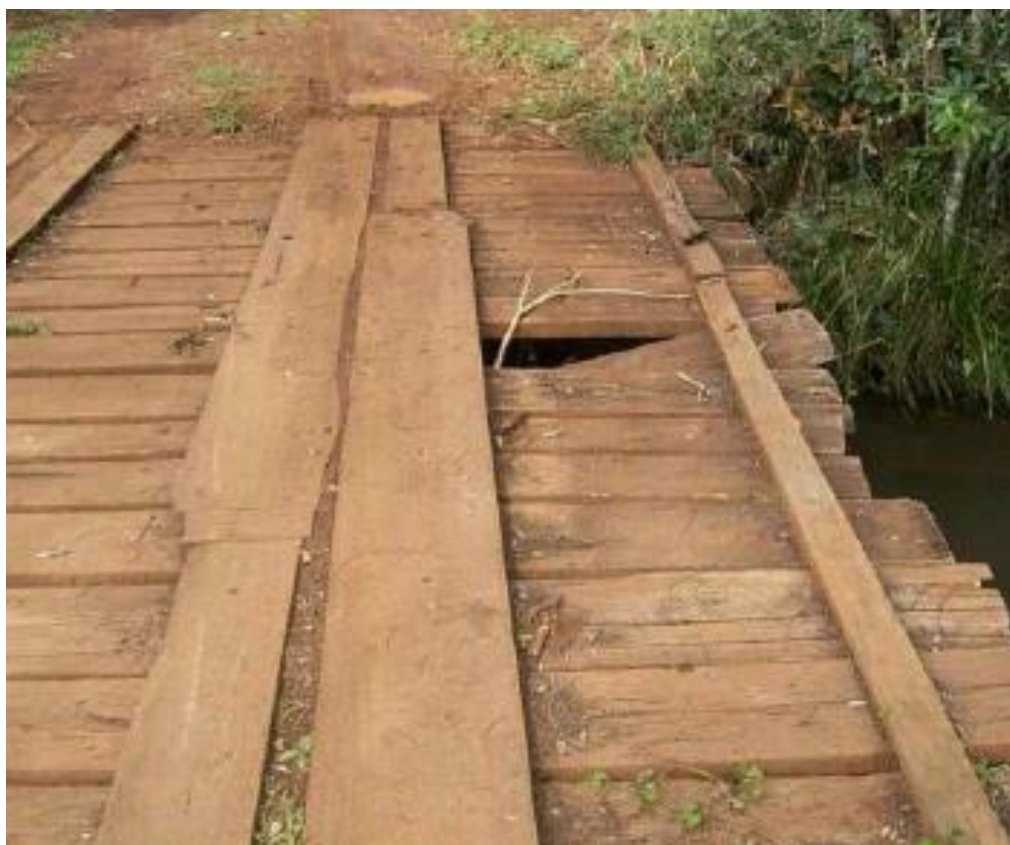
Figura 23: Danos nos tabuleiros em pontes do município de Pato Branco (2) Fonte: Milani, 2010.
