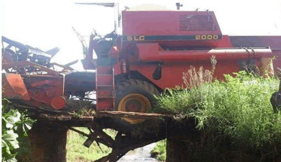
Figura 21: Ponte que quebrou durante a travessia de uma colheitadeira Fonte: Veja Coronel, 2015.
