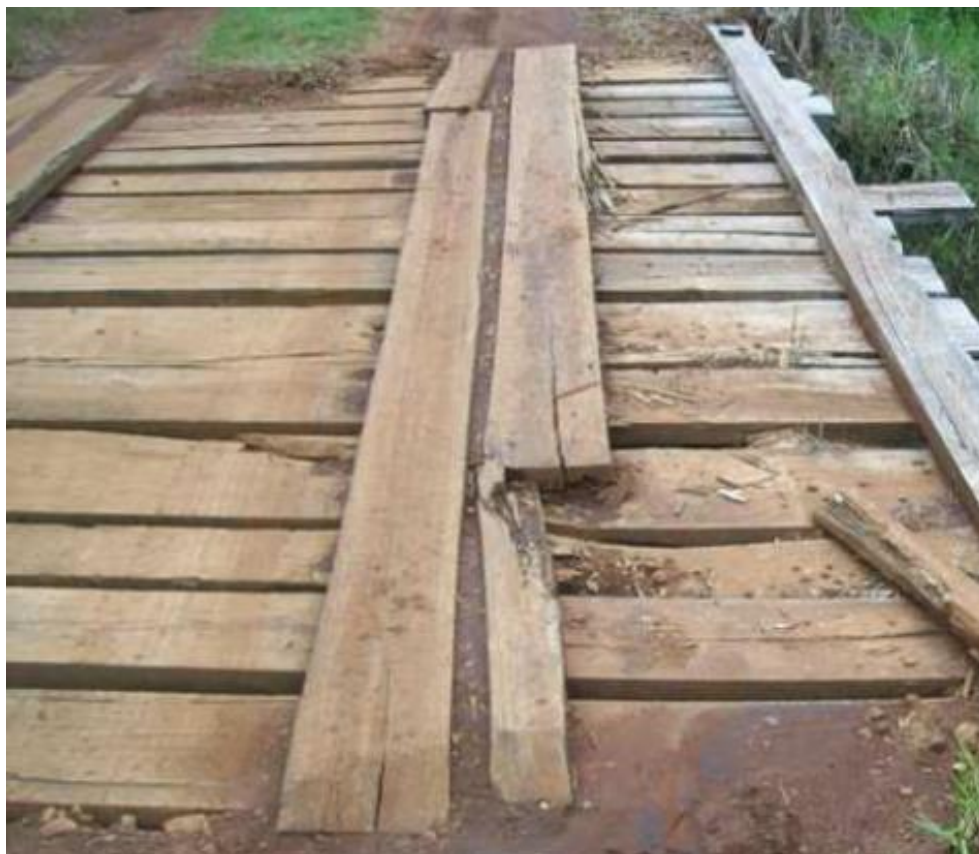
Figura 22: Danos nos tabuleiros em pontes do município de Pato Branco (1) Fonte: Milani, 2010.
