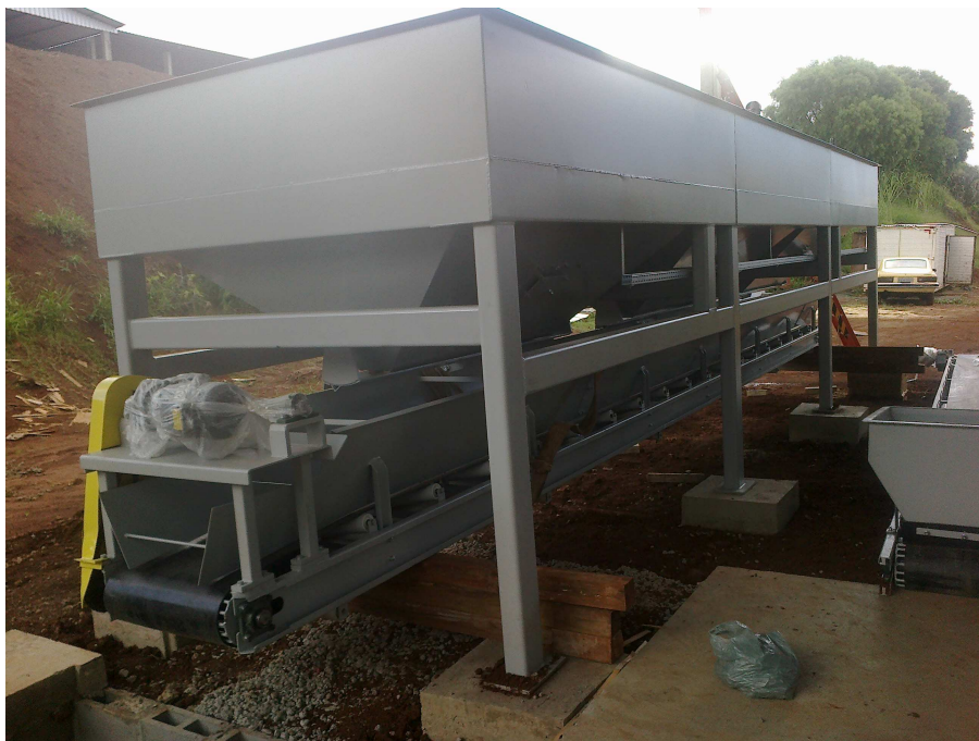
Figura 6 Silo de armazenamento de agregados Fonte: Autoria própria (2015)
