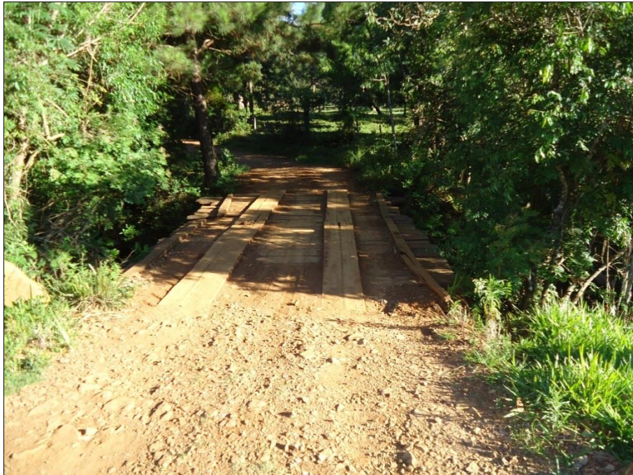
Figura 33 - Ponte 09: Rodeio Danificado. Fonte – Os Autores (2013).
