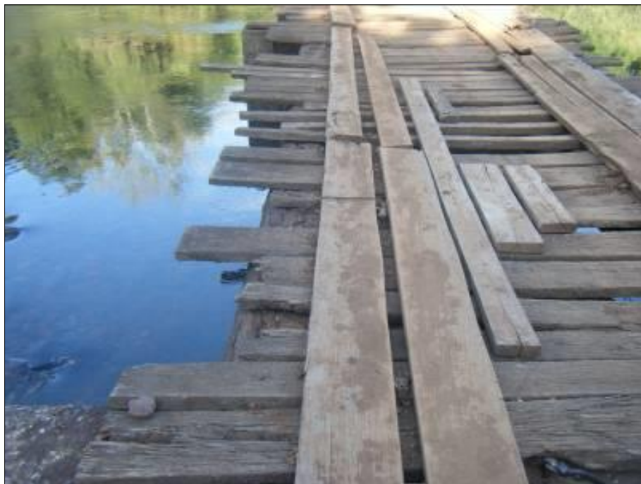
Figura 29 - Ponte 05: Rodeio com Peças Soltas e Transversinas Quebradas. Fonte - Borsatti (2013).
