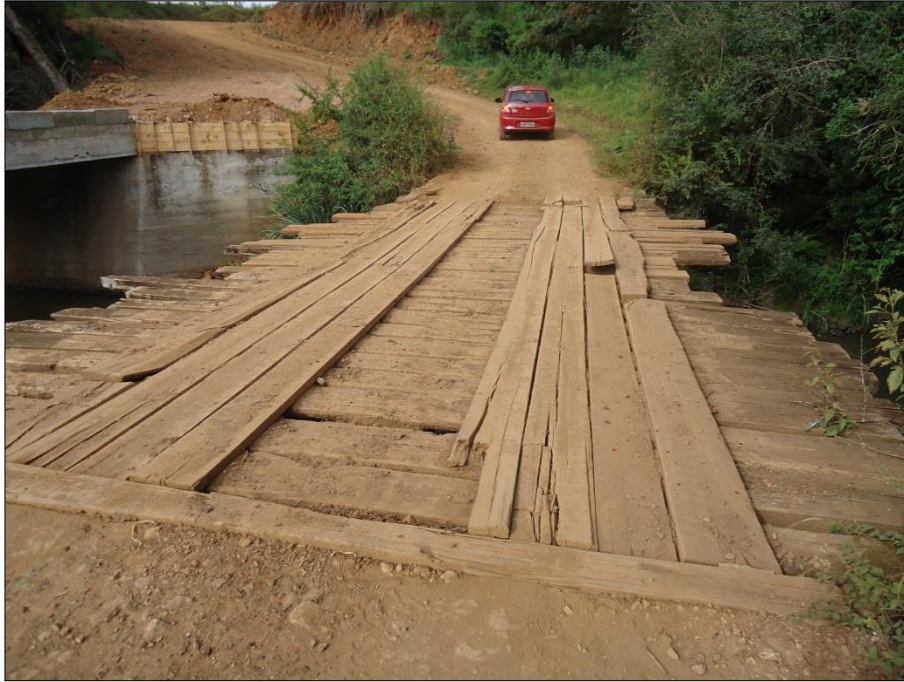
Figura 34 - Ponte 10: Rodeio Danificado. Fonte – Os Autores (2013).
