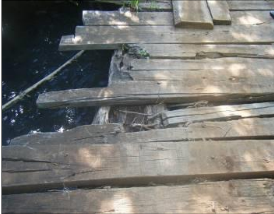
Figura 26 - Ponte 02: Transversina Danificada, Ausência Guarda-Rodas e Defensas. Fonte - Borsatti (2013).
