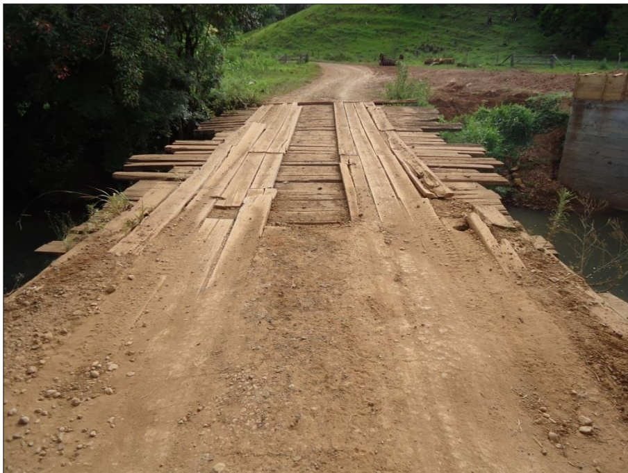
Figura 35 - Ponte 11: Rodeio e Transversina Danificados. Fonte - Os Autores (2013).
