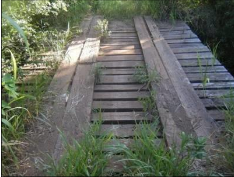
Figura 30 - Ponte 06: Excesso de Vegetação. Fonte - Borsatti (2013).
