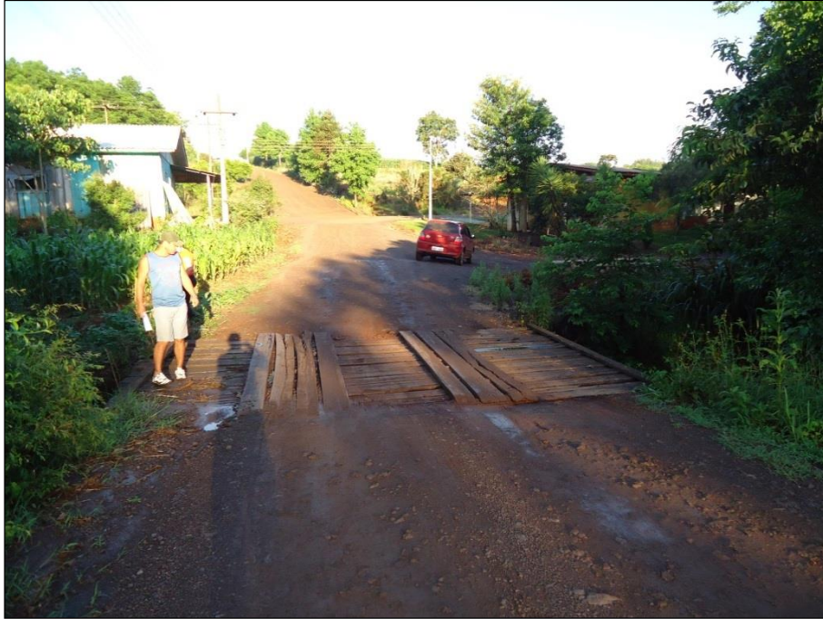
Figura 32 - Ponte 08: Rodeio Danificado. Fonte – Os Autores (2013).
