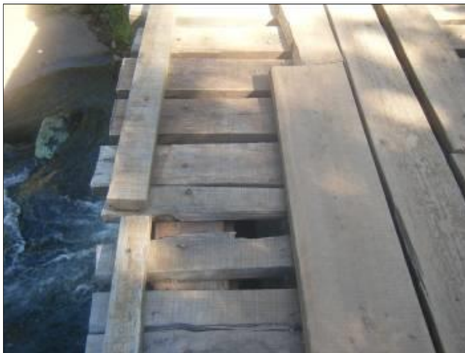
Figura 25 - Ponte 01: Rodeio com Peças Soltas, Defeito nas Transversina, Inexistência de Defensas.
