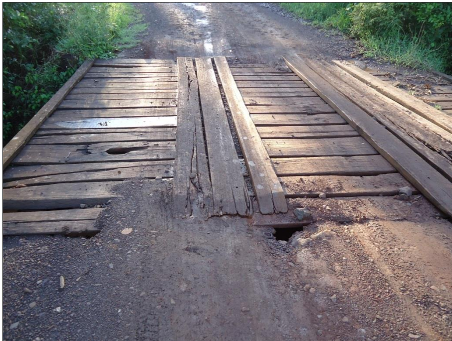
Figura 31 - Ponte 07: Estrutura Comprometida. Fonte – Os Autores (2013).
