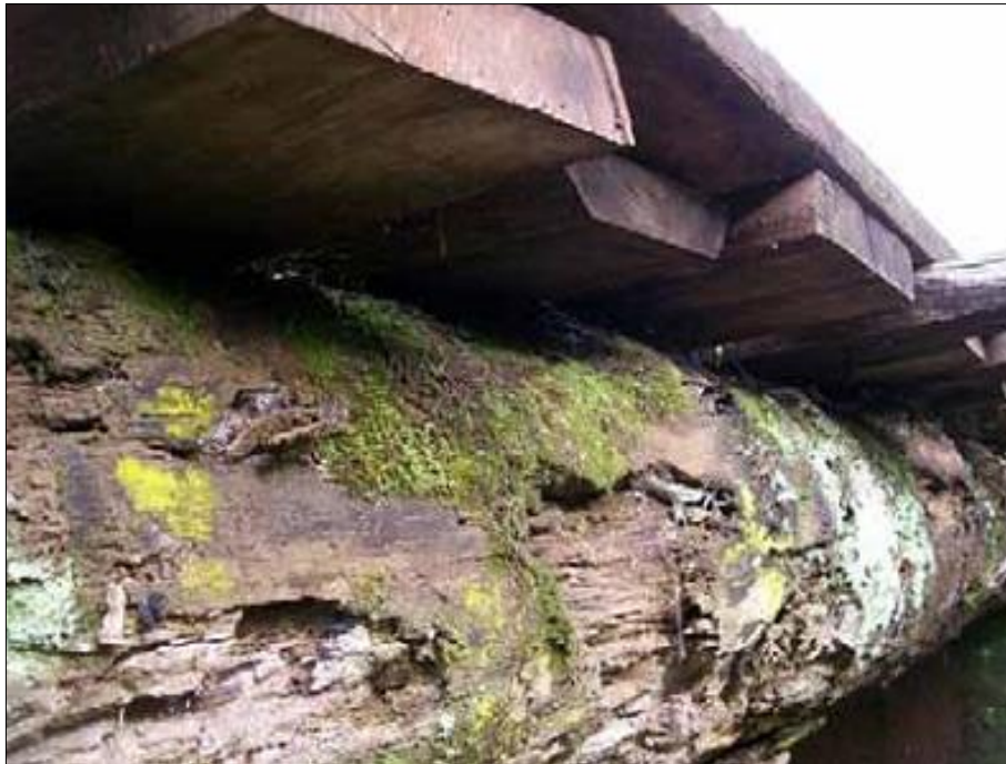
Figura 38 - Detalhe da Viga de Suspensão Danificada por Ataque de Fungos. Fonte - Milani (2010).
