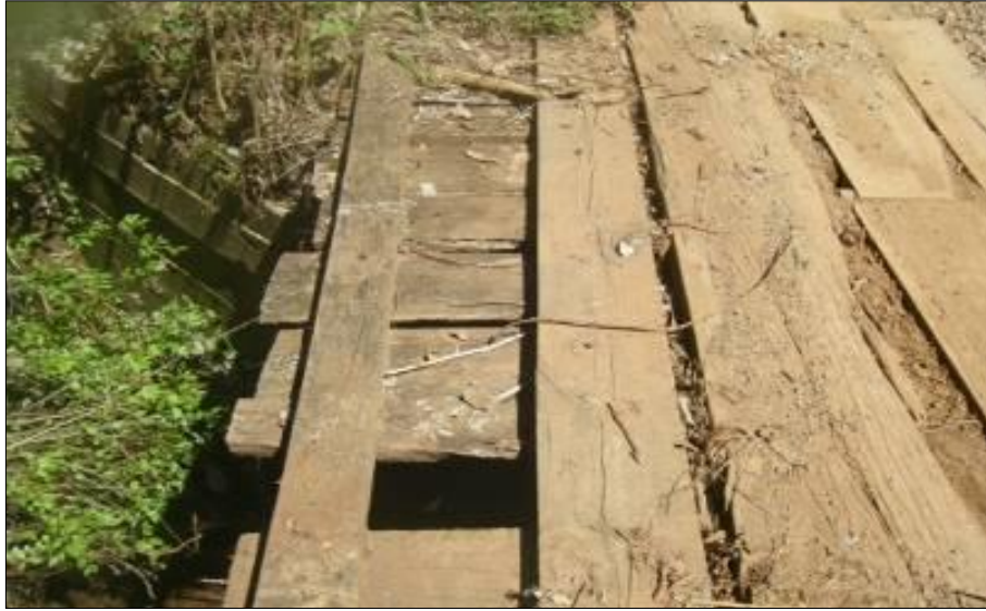
Figura 28 - Ponte 04: Rodeio Danificado. Fonte - Borsatti (2013).
