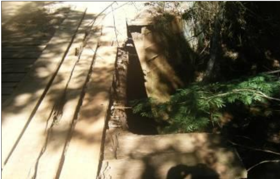
Figura 27 - Ponte 03: Rodeio Desgastados e Transversinas Quebradas. Fonte - Borsatti (2013).
