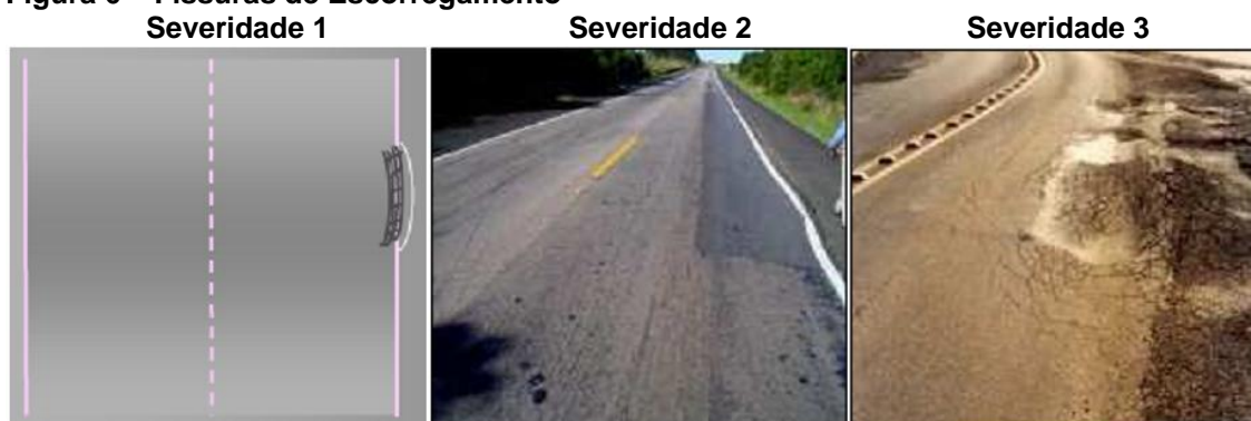
Figura 6 – Fissuras de Escorregamento
