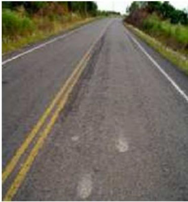
Figura 10 – Desgaste Superficial Severidade 1
