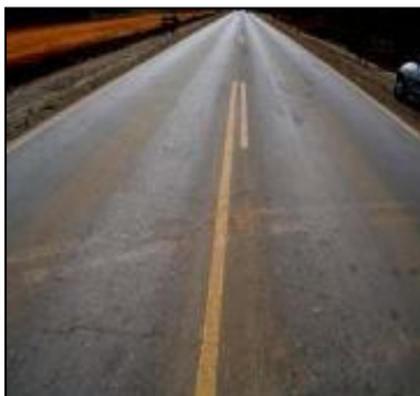
Figura 4 – Trincamento Transversal Severidade 1
