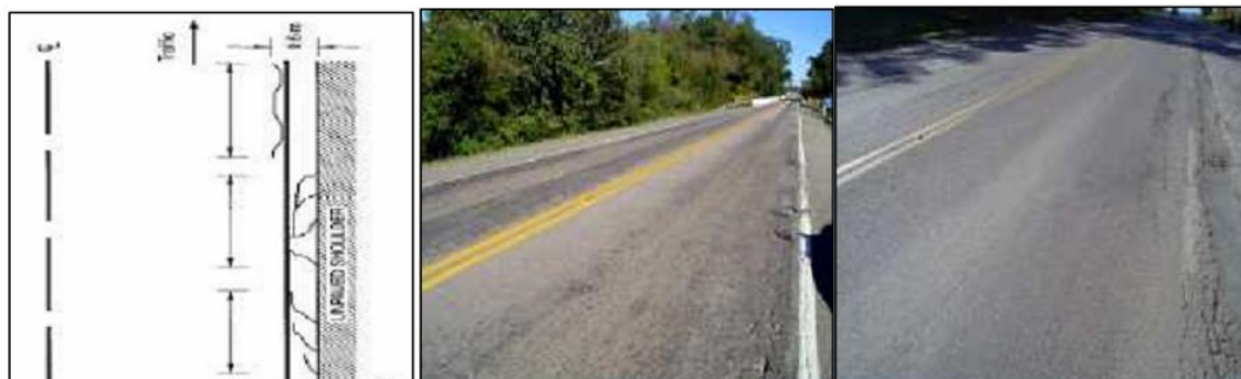
Figura 7 – Fissuras de Bordo Severidade 1
