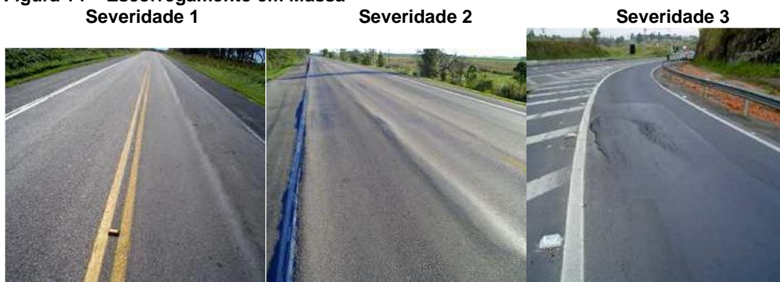
Figura 14 – Escorregamento em Massa
