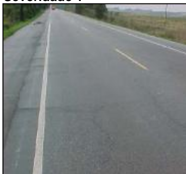
Figura 2 – Fissuras em Blocos Severidade 1
