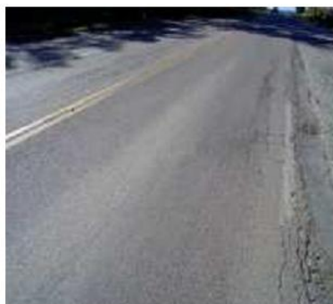
Figura 11 – Erosão de Bordo Severidade 1
