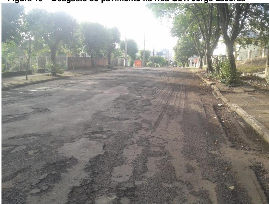
Figura 16 – Desgaste do pavimento na Rua Gov. Jorge Lacerda
