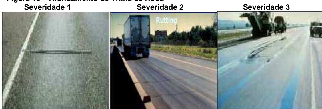
Figura 13 – Afundamento de Trilha de Roda
