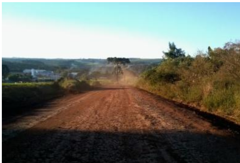
Figura 06 – Rua Tocantis saída para a Rua Artibano Sutile.
