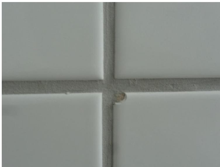
Figura 8 – Fotografia - Defeito provavelmente causado por impacto Fonte: Autoria própria.
