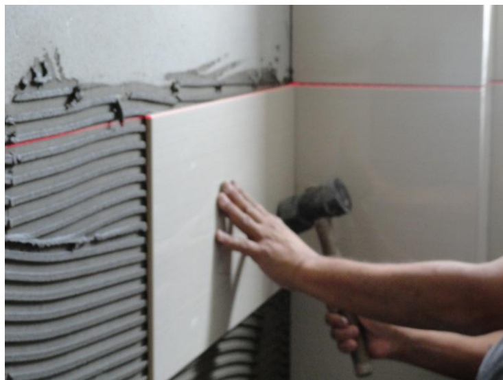
Figura 14 – Fotografia - Colocação da primeira peça da fiada – Apt. “B” Fonte: Autoria própria.
