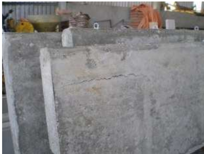
Fotografia 13 – Fissuras Fonte: Autoria Própria
