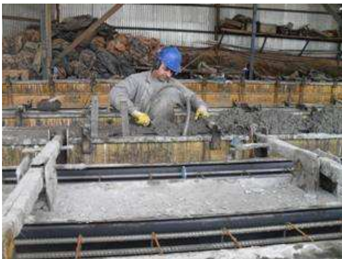
Fotografia 16 – Vibração inadequada: próximo as faces da forma. Fonte: Autoria própria
