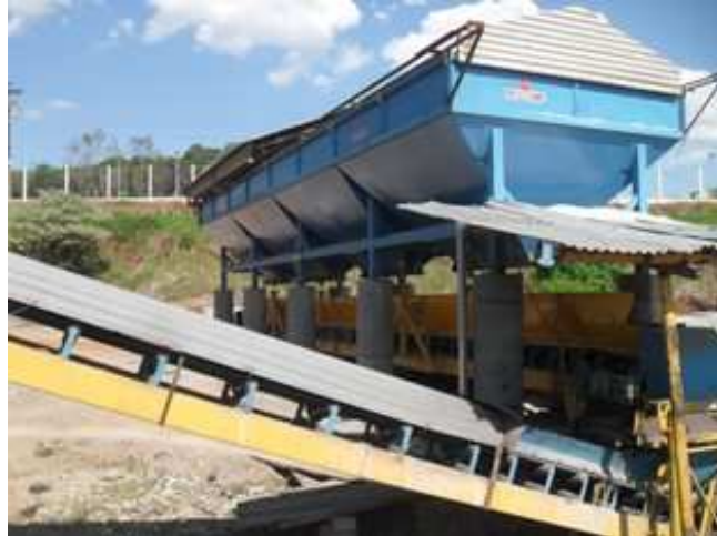
Fotografia 5 – Agregados armazenados em silos Fonte: Autoria própria
