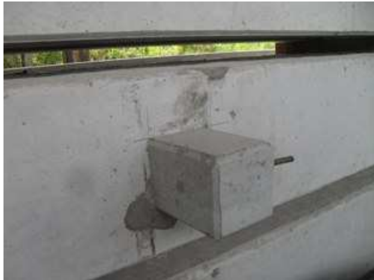
Fotografia 18 – Acabamento Inadequado Fonte: Autoria própria
