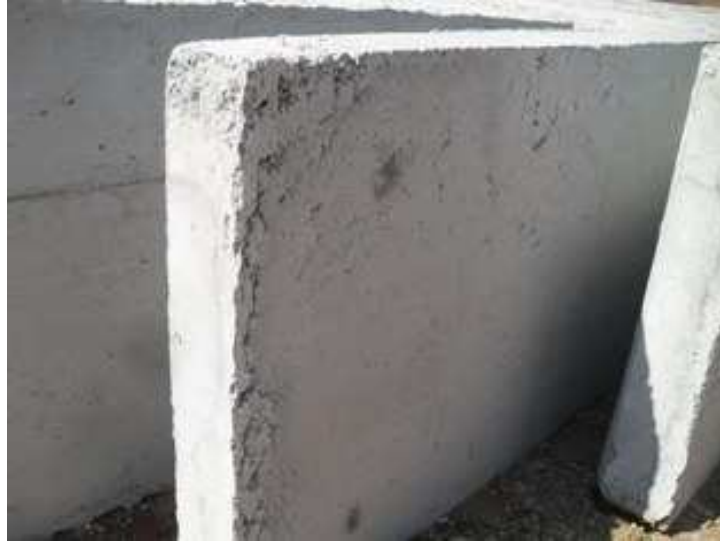
Fotografia 17 – Adensamento inadequado Fonte: Autoria própria
