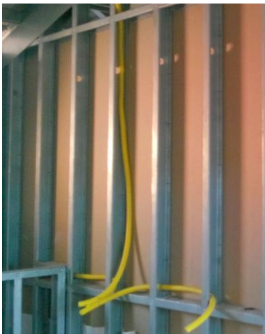
Figura 42 – Instalações elétricas no sistema steel frame Fonte: Autoria Própria (2014).
