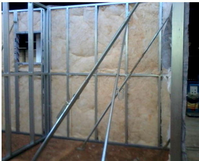
Figura 40 – Isolamento termoacústico com lã de vidro Fonte: Autorial Própria (2014).
