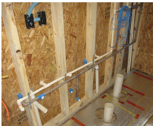
Figura 16 – Instalação hidrossanitária no sistema wood frame Fonte: Tecverde.
