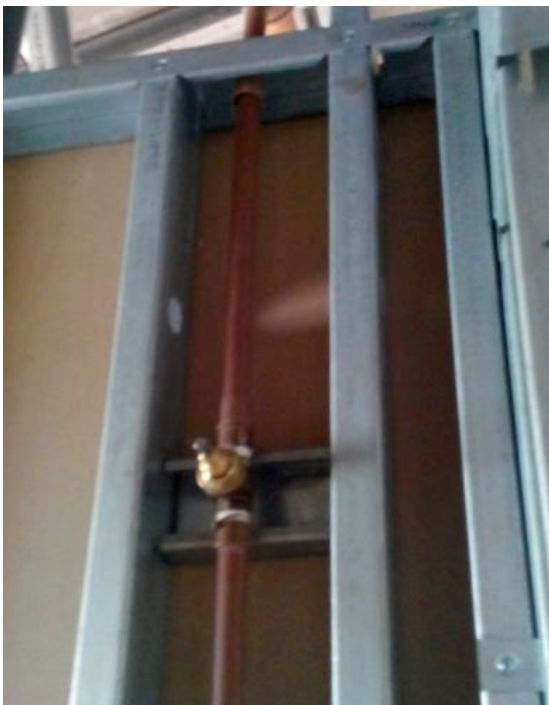
Figura 44 – Instalação hidrossanitária no sistema steel frame Fonte: Autoria Própria (2014).
