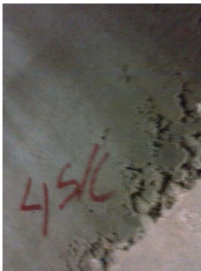
Figura 27 – Ausência de Argamassa no Concreto Fonte: Autoria Própria
