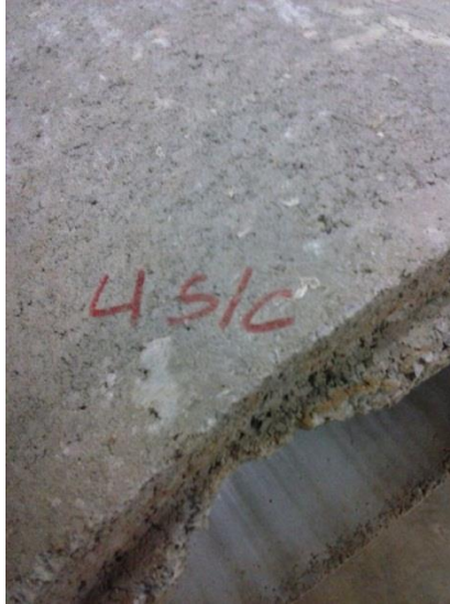
Figura 28 – Patologia Gerada no Macho do Tubo pela Ausência de Argamassa no Concreto Fonte: Autoria Própria
