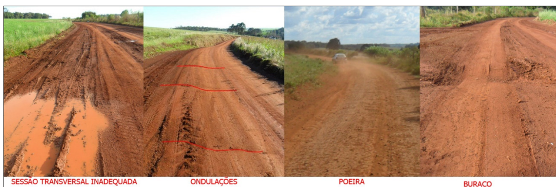
Figura 30 - Defeitos encontrados na Subseção 2 FONTE: Aatoria Própria (2014).
