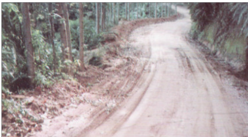
Figura 7 – Defeito: Afundamento de trilho de roda FONTE: Baesso e Gonçalves (2003).
