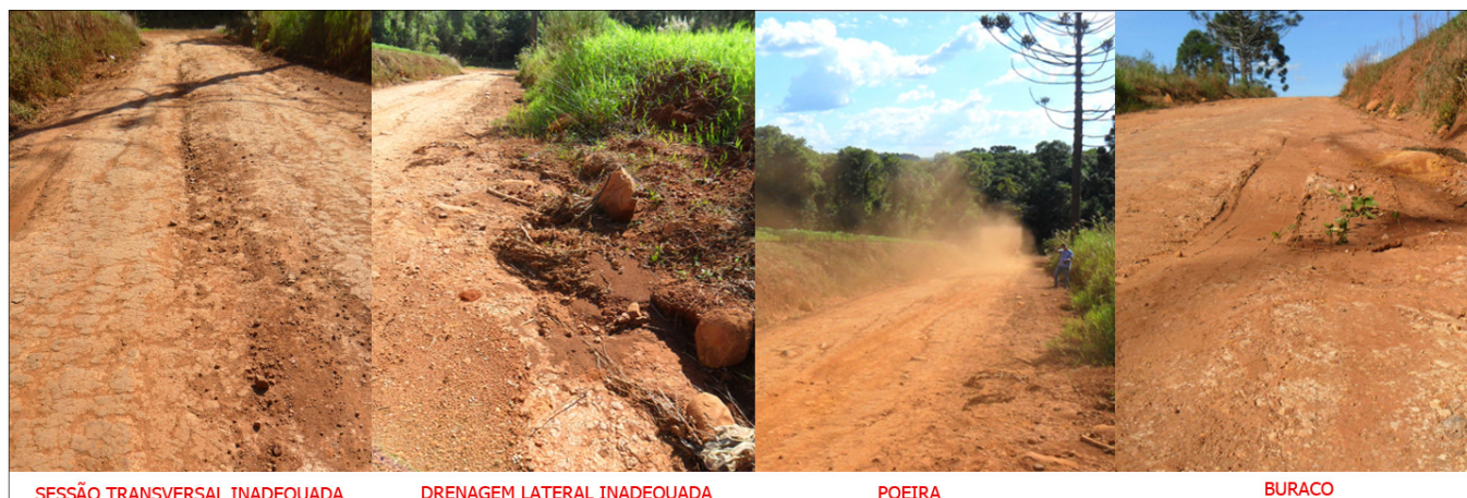
Figura 31 - Defeitos encontrados na Subseção 3 FONTE: Aatoria Própria (2014).
