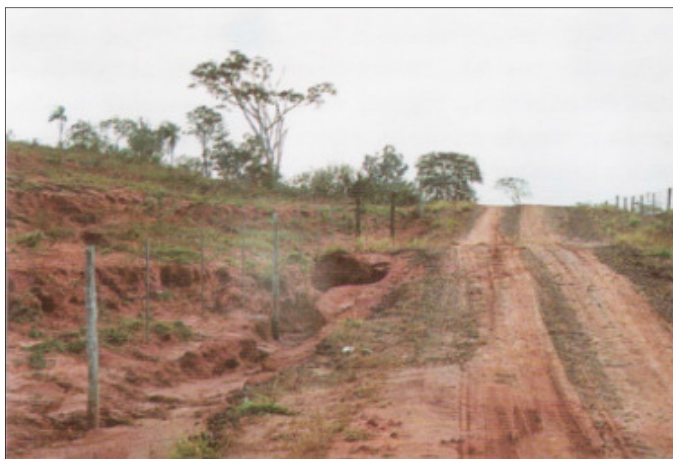
Figura 8 – Defeito: Erosão FONTE: Baesso e Gonçalves (2003).
