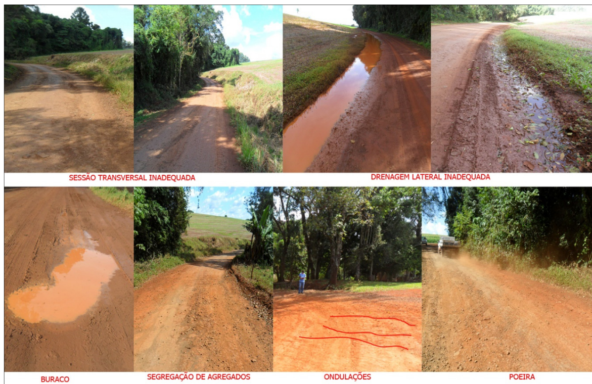
Figura 27 - Defeitos encontrados na Subseção 1 FONTE: Autoria Própria (2014).
