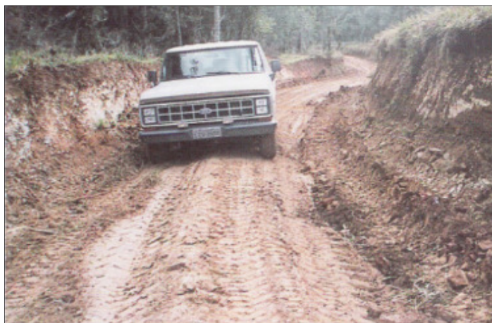
Figura 5 – Defeito: Sessão transversal inadequada FONTE: Baesso e Gonçalves (2003).
