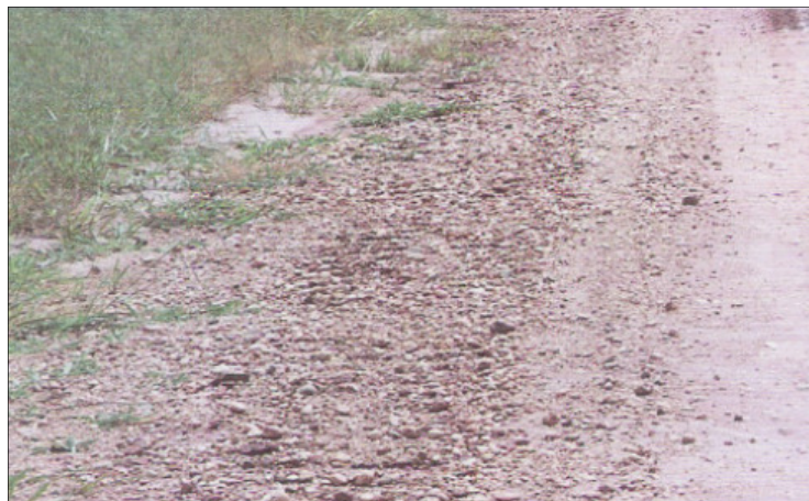
Figura 3 – Defeito: Segregação de agregados FONTE: Baesso e Gonçalves (2003).
