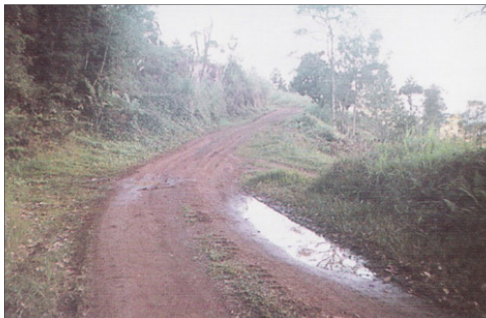
Figura 9 - Defeito: Drenagem lateral inadequada FONTE: Baesso e Gonçalves (2003).
