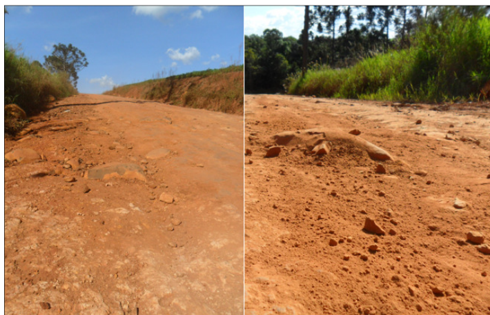
Figura 32 - Defeito: Afloramento de rocha subseção 3 FONTE: Aatoria Própria (2014).
