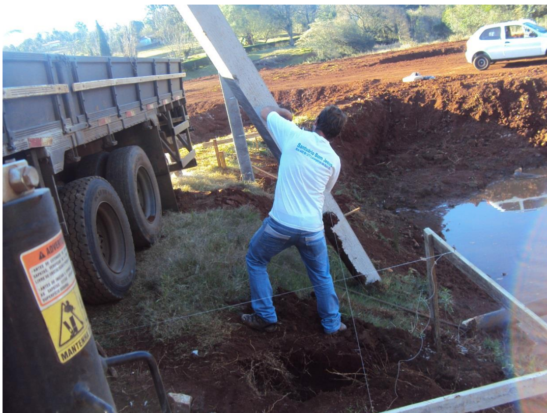
Figura 4 - Pilar sendo descarregado sem o uso de EPIs Fonte: Autoria própria (2013)
