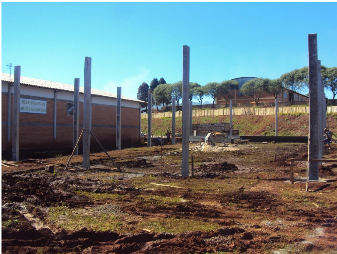
Figura 12 - Galpão em fase de execução sem isolamento requerido por norma Fonte: Autoria própria (2013)
