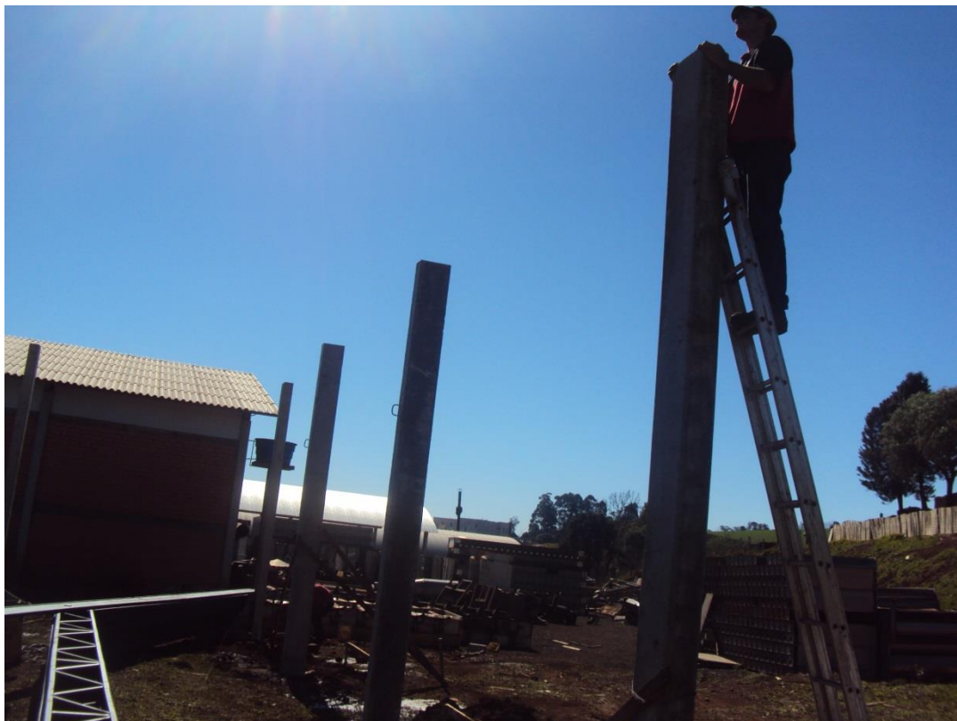
Figura 3 – Trabalhador sobre escada de mão sem proteção contra queda Fonte: Autoria própria (2013)
