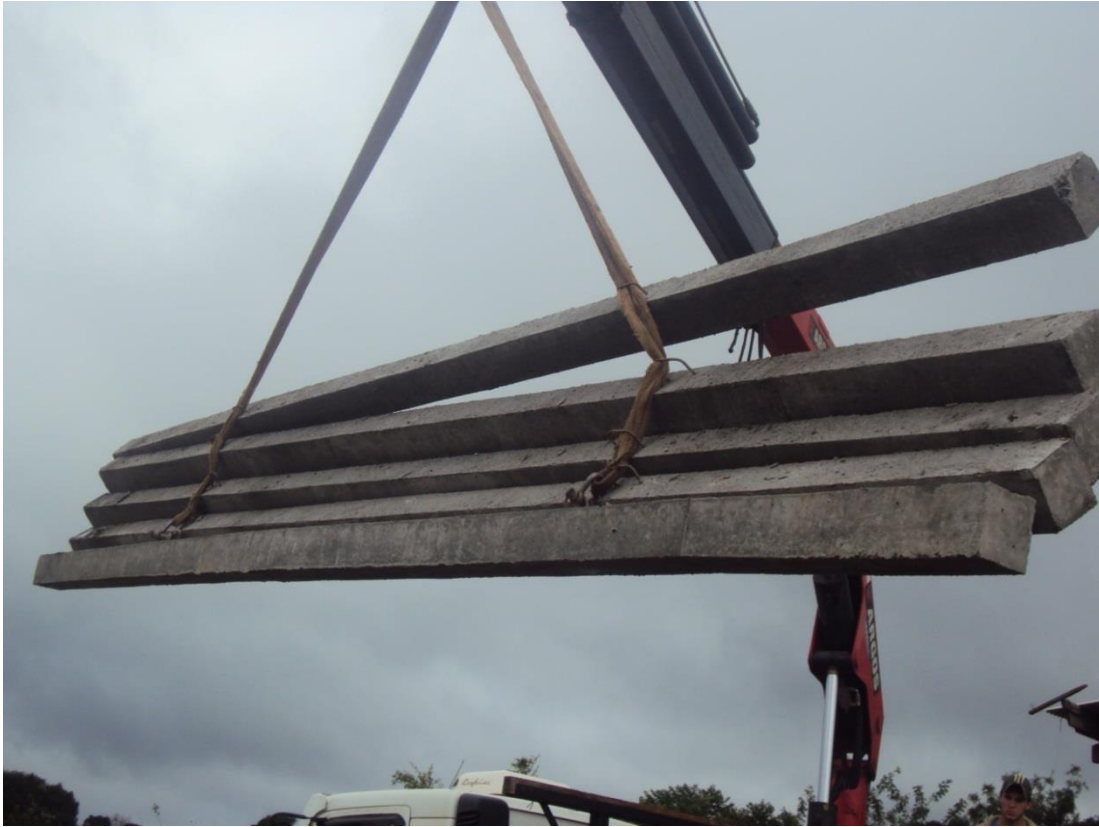
Figura 9 - Pilares sendo içados de maneira incorreta Fonte: Autoria própria (2013)
