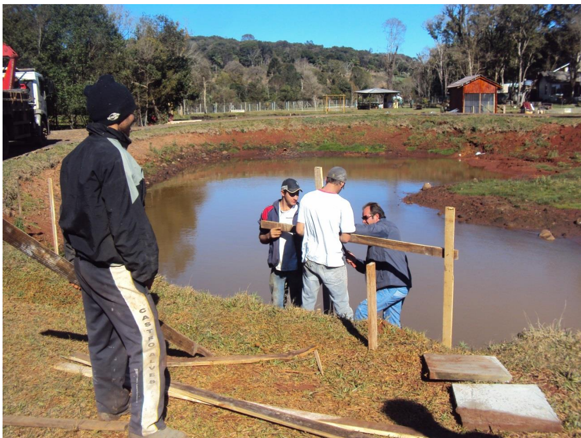
Figura 6 - Funcionários locando a obra sem EPIs Fonte: Autoria própria (2013)
