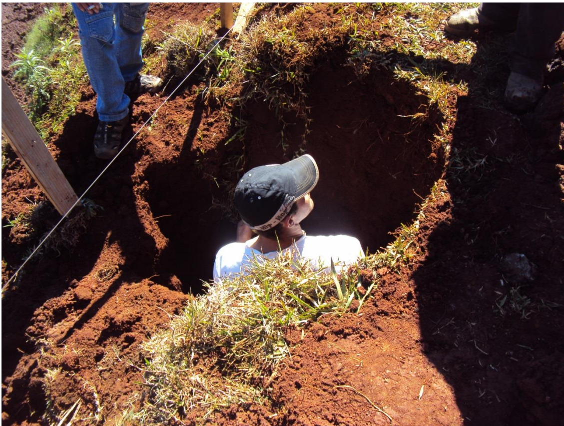
Figura 7 - Escavação manual sendo realizada de maneira incorreta Fonte: Autoria própria (2013)
