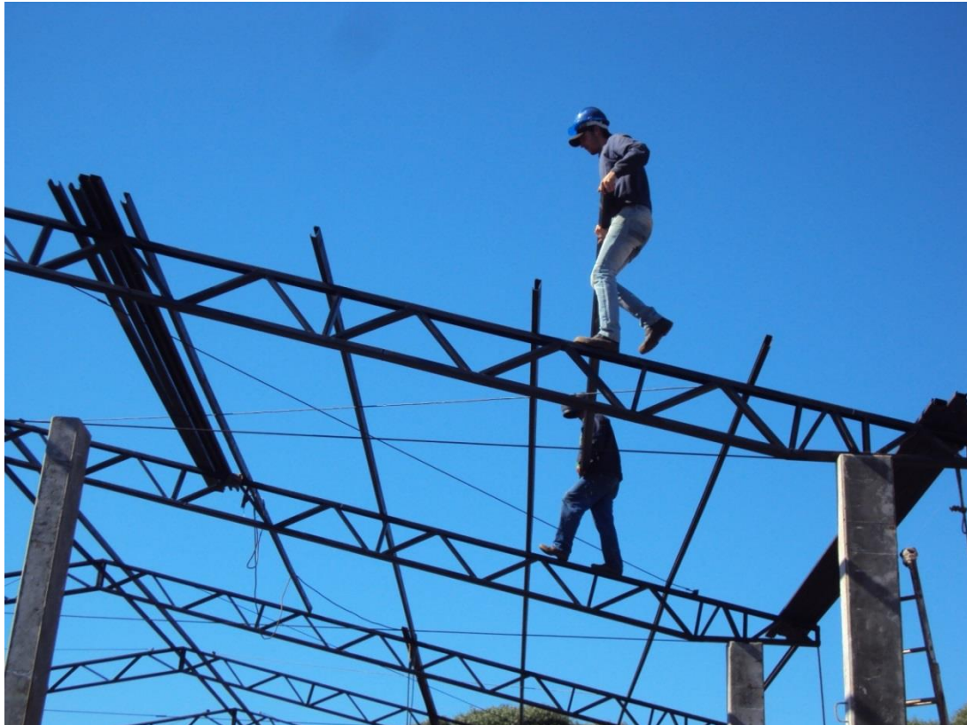
Figura 11 - Execução da cobertura sem equipamentos de proteção contra queda em altura Fonte: Autoria própria (2013)
