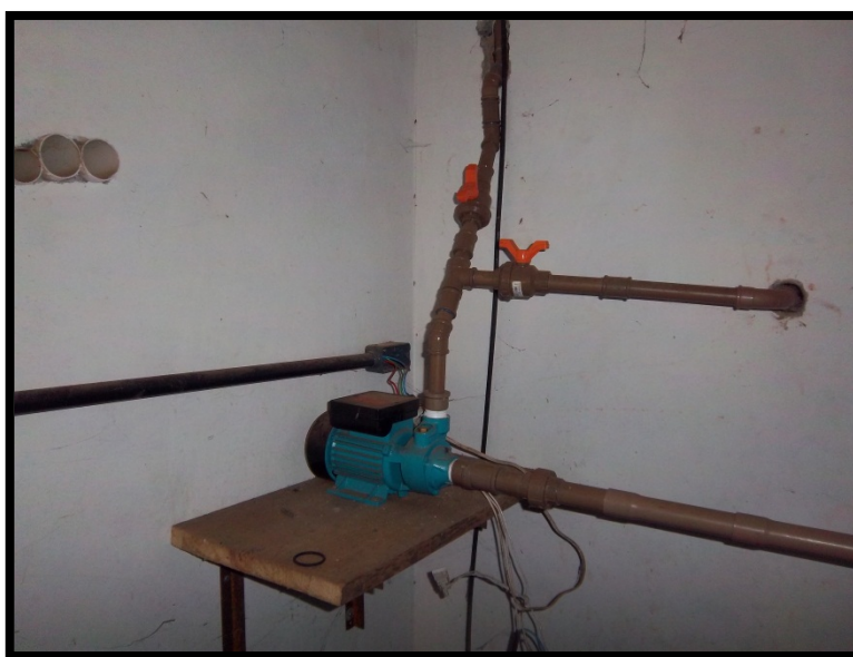
Figura 21 - Motor para bombeamento da água para o reservatório superior
