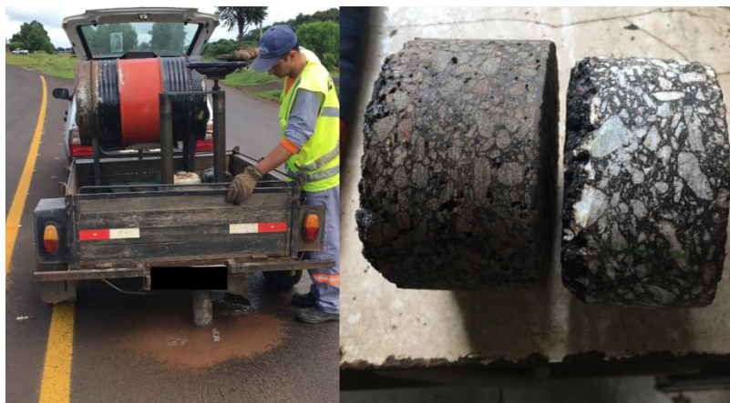
Figura 5: Extração de corpo de prova através de sonda rotativa (esq.) e corpos de prova (dir.) Fonte: Autoria própria (2018).
