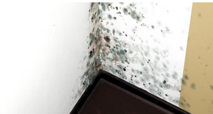
Figura 11: Bolor em parede
