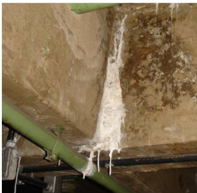
Figura 10: Eflorescência em estrutura de concreto Fonte: SOUZA (2008).
