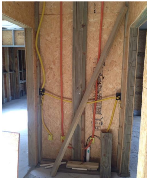
Figura 6 – Instalação elétrica Fonte: Atos arquitetura (2017).
