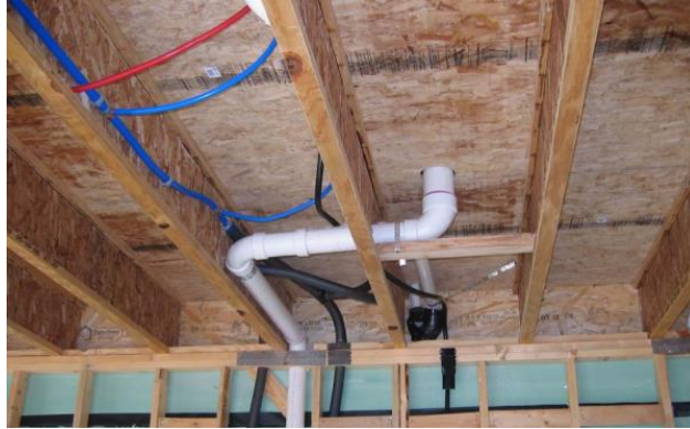
Figura 5 – Instalação hidráulica Fonte: Globalplac (2017).
