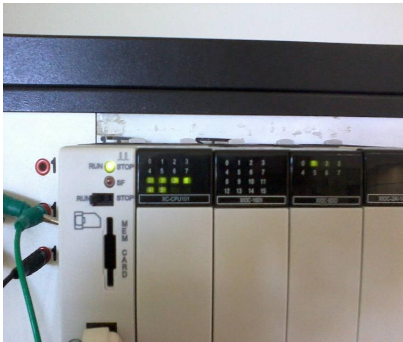
Figura 21 - Leds indicando que as saídas do CLP estão acionadas.
