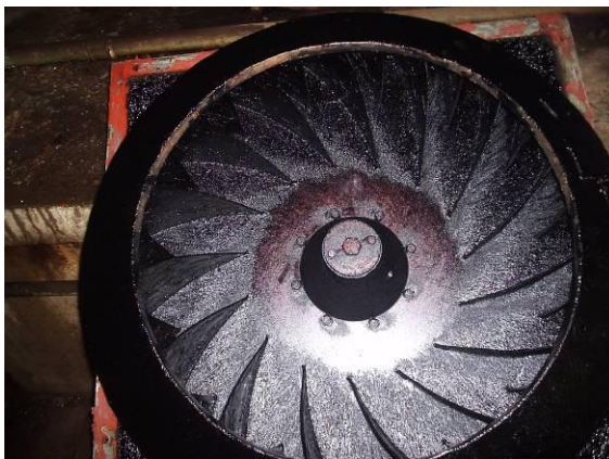
Figura 24 - Turbina retirada para higienização e balanceamento.
