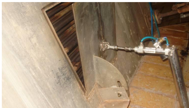
Figura 27- Renovação de ar aberta.
