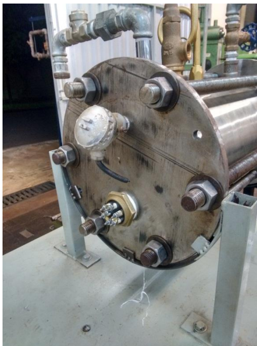
Figura 14- Sensor de Temperatura e Resistência já Instalados.
