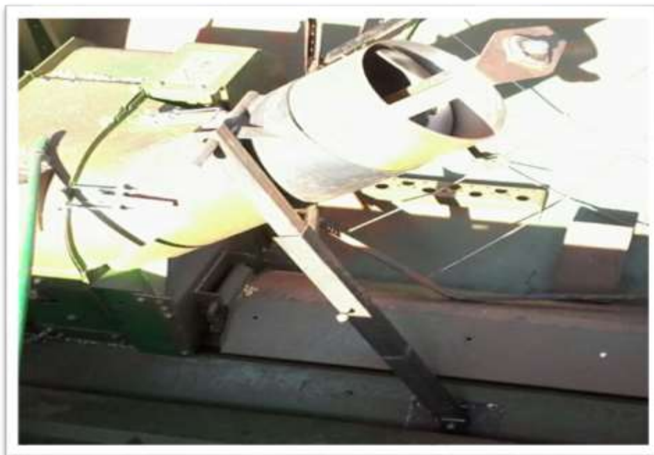
Figura 12: Suporte de Elevação do Sem-fim Elevado e Travado. Fonte: Autoria Própria.
