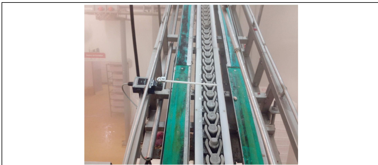
Figura 16 – Sensor fim de curso 1 instalado Fonte: Autor
