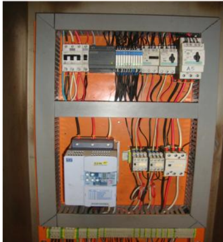
Figura 28 – Detalhe Interno do Novo Painel Elétrico
