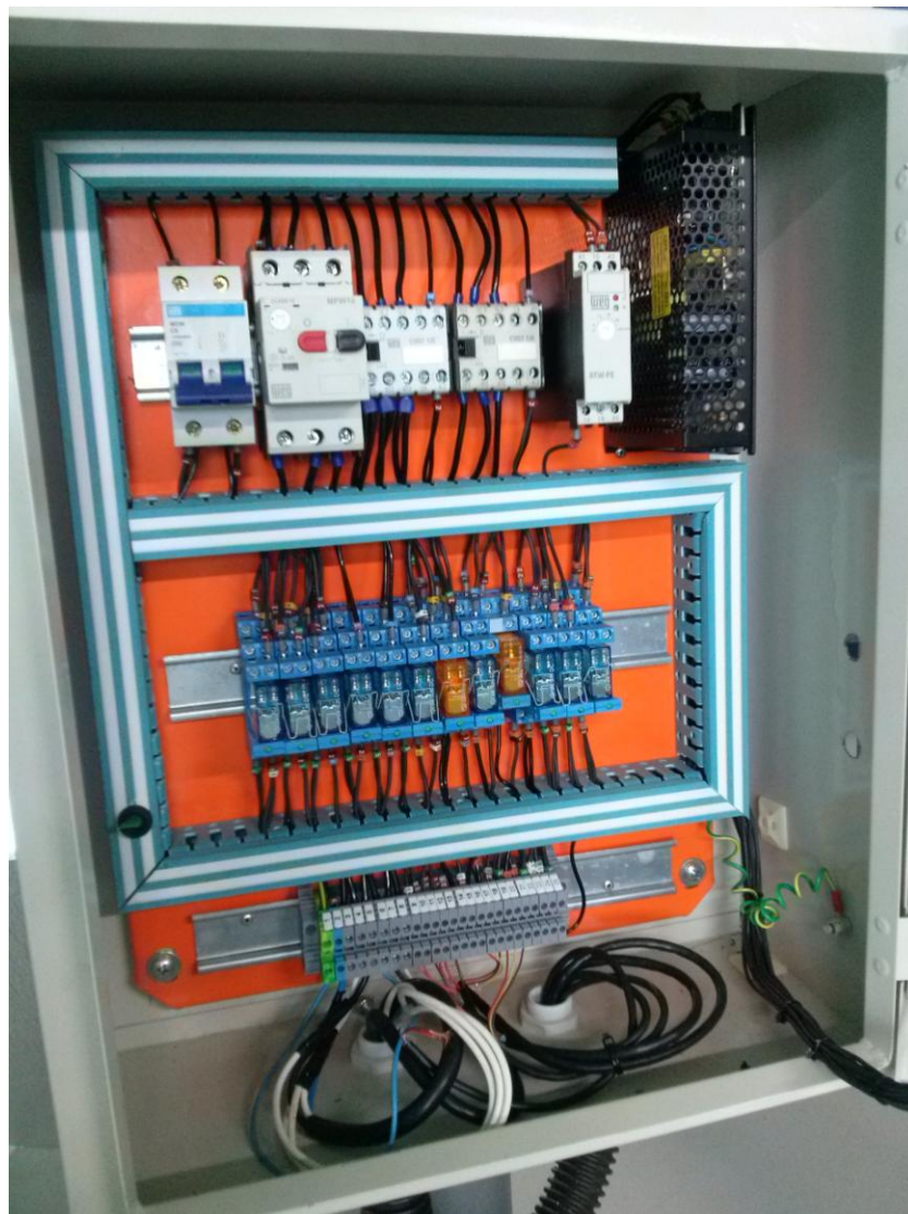
Figura 5 - Vista Interna do Quadro de Comando
