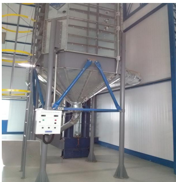
Figura 7 - Silo Resfriador com Kit de Automação
