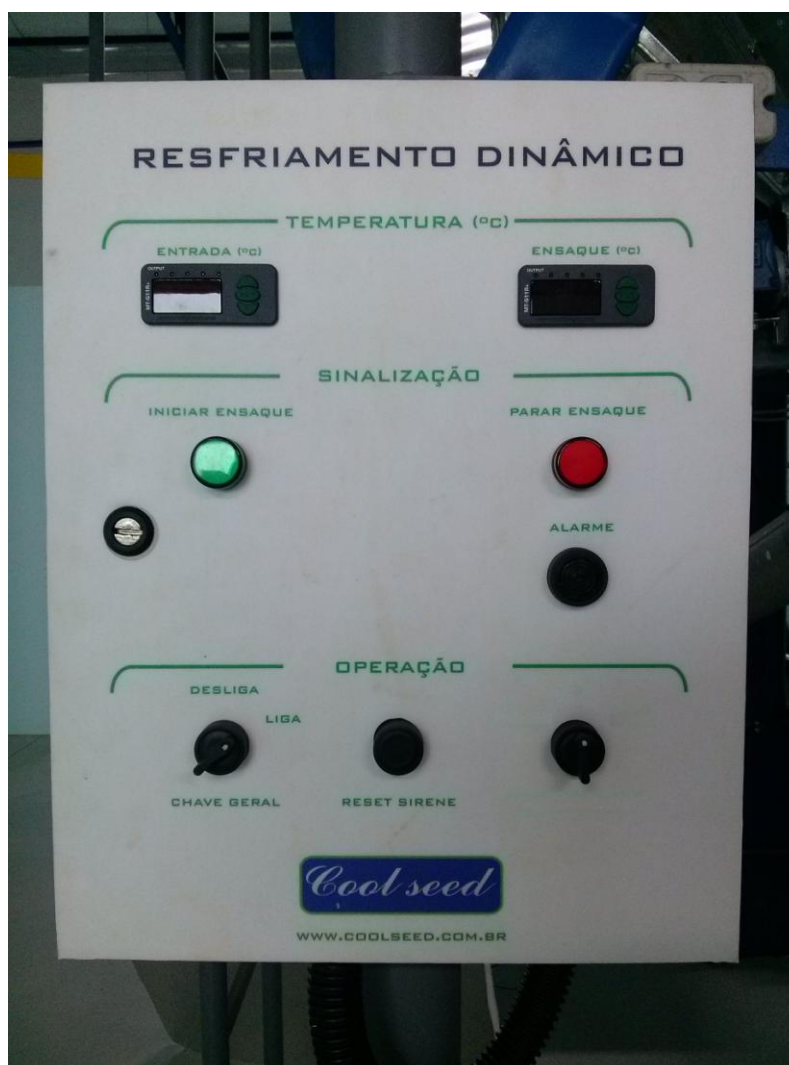
Figura 6 - Vista Externa do Quadro de Comando
