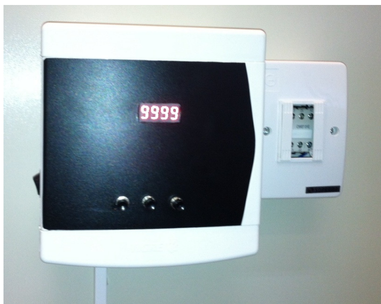
Figura 22: Equipamento Contador instalado.
