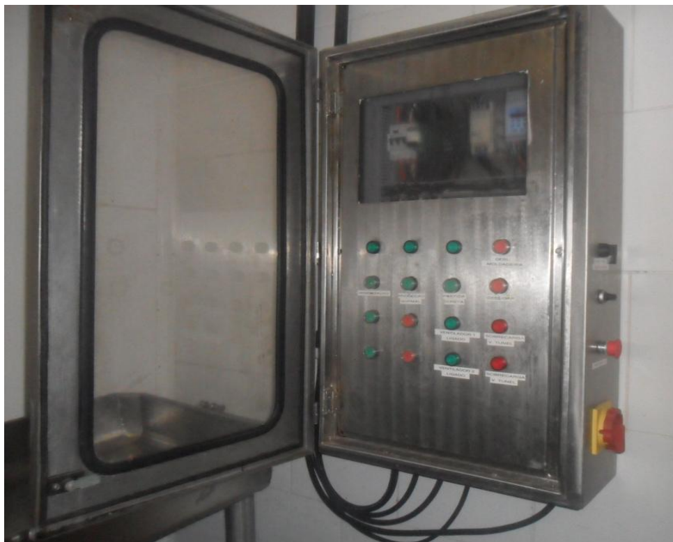
Figura 22 - Vista frontal do painel elétrico finalizado.
