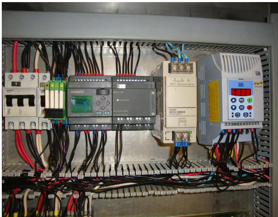
Figura 24 - Vista frontal do CLP e do inversor de frequência utilizados.
