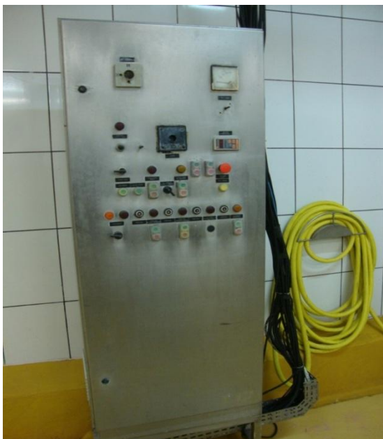
Figura 9 - vista frontal do painel elétrico do túnel de congelamento.
