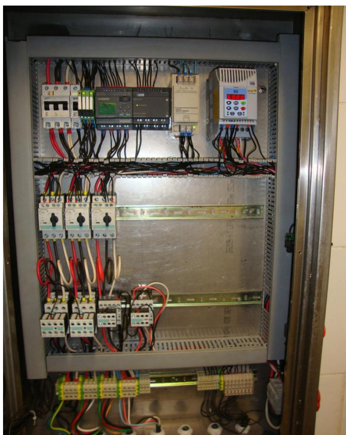
Figura 25: Vista dos componentes internos do painel elétrico finalizado.
