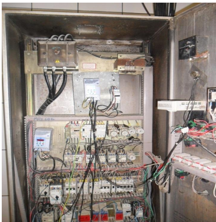
Figura 10 - vista frontal dos componentes internos do painel.
