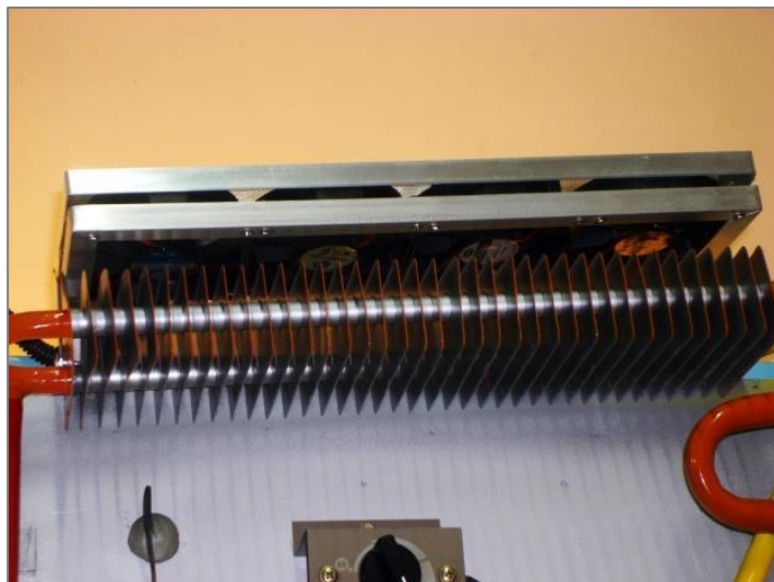
Figura 10. Sistema de ventilação forçada.
