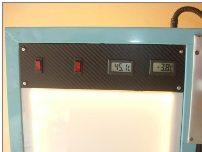
Figura 14. Painel de comando
