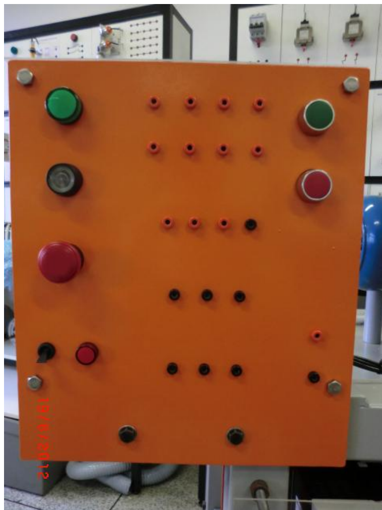
Figura 9 - Painel montado com todos os componentes instalados
