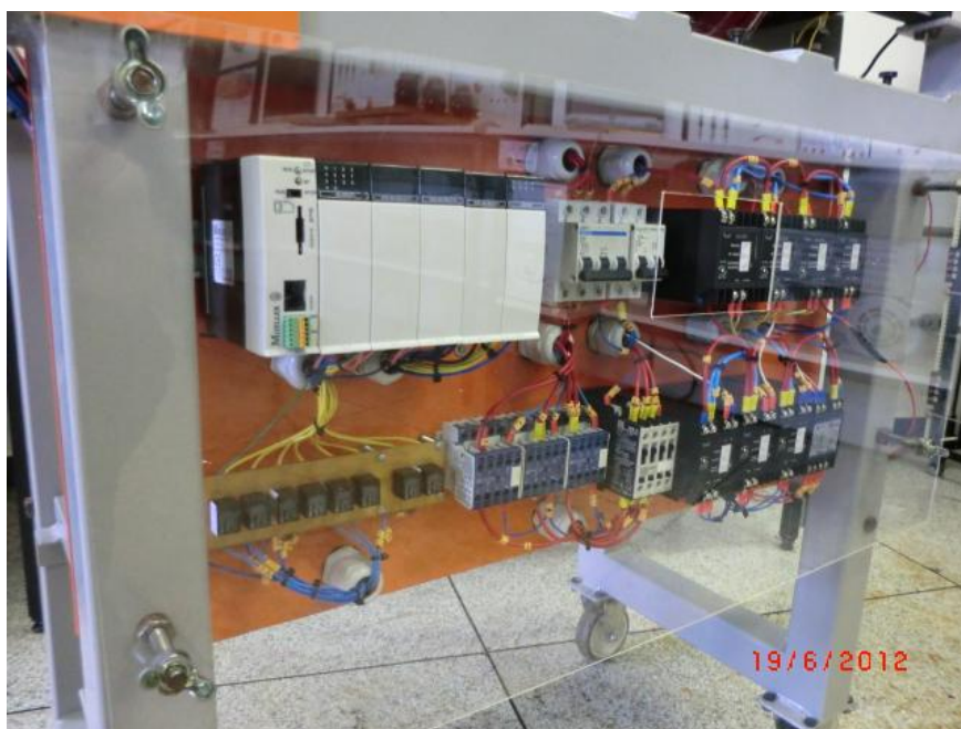
Figura 7 - Painel inferior com os componentes instalados
