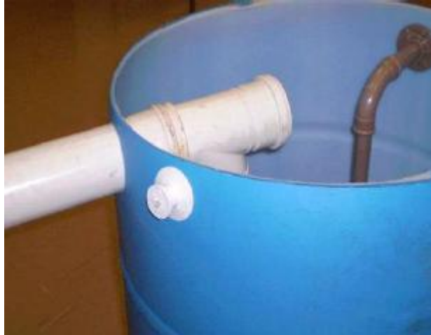
Figura 17: Plug fixado para prender o sistema clorador
