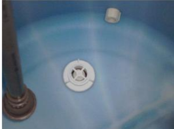
Figura 15: Ralo para limpeza da cisterna .
