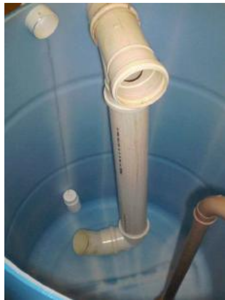
Figura 16: Sistema clorador para desinfecção da água armazenada.
