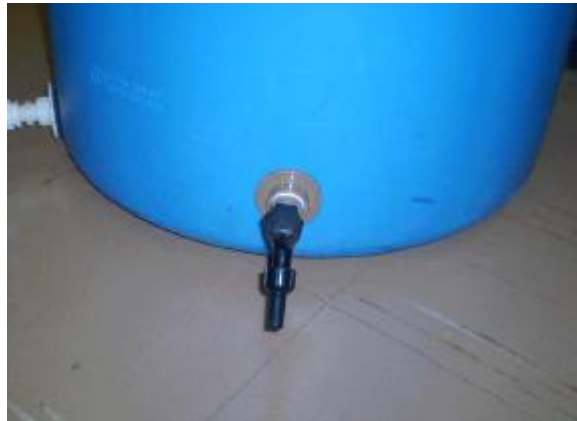
Figura 14: Torneira para retirada da água da cisterna.
