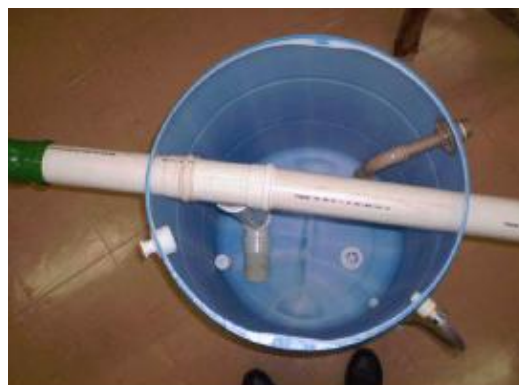
Figura 13: Sistema de entrada da água na cisterna.
