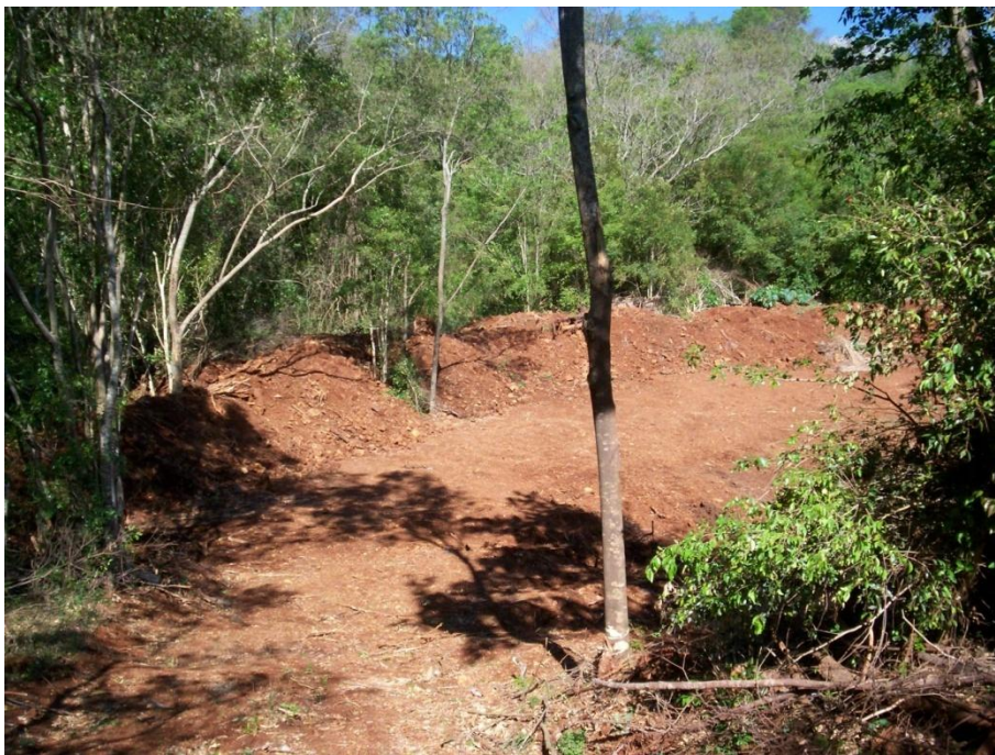
Figura 4 – Nivelamento de isolamento no entorno da área do sitio de extração. Março de 2011.
