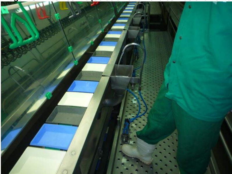
Imagem 02 – Demosntração de uma torneira com acionamento por pedal
