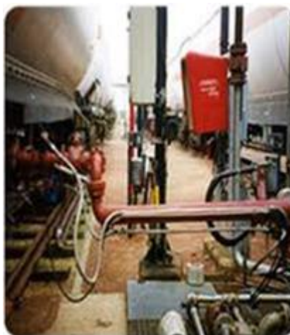
Figura 10 - Carregamento do tipo Bottom Loading (BL)
