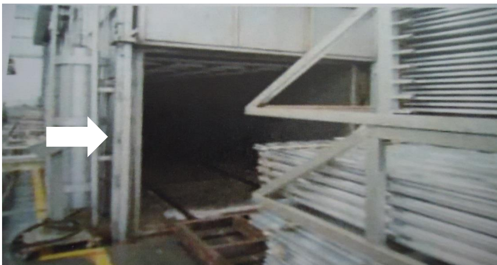
Figura 21 - Forno de tratamento térmico. Fonte: O autor.
