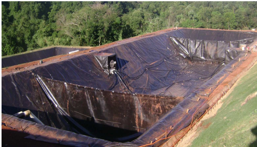
Figura 10 – Visão geral interna do biodigestor
