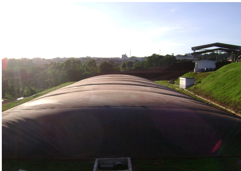
Figura 9 – Visão do biodigestor de 2.500 m 3 em escala real
