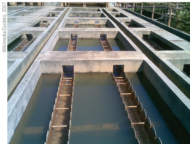
Etapa de decantação em uma estação de tratamento de água
