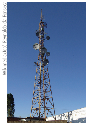
Torre metálica de antenas repetidoras (microondas)
