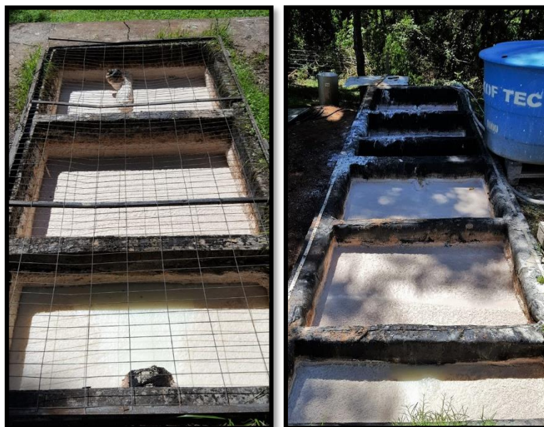
Figura 6 – Tratamento Preliminar: Caixas de Gordura 1 (com grade de proteção) e 2 (sem grade de proteção) Fonte: Autoria própria, 2016
