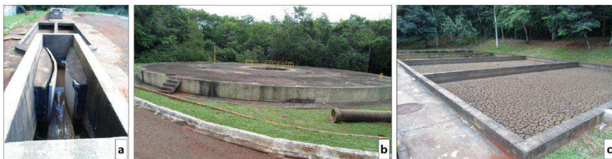
Figura 6: (a) Caixa de areia e Calha Parshall; (b) RALF; (c) Leito de secagem.
