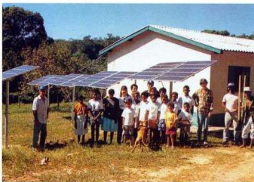
Figura 6 - Sistema isolado de geração de energia fotovoltaica na comunidade de Boa Sorte – MS.
