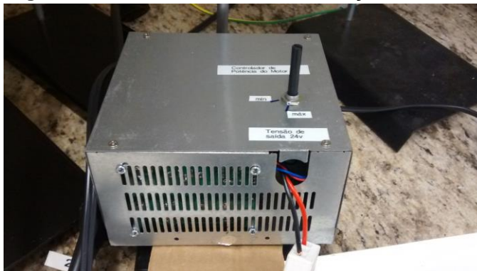
Figura 15 – Caixa controladora de rotação do motor.
