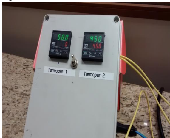
Figura 11 – Caixa de controle em funcionamento.
