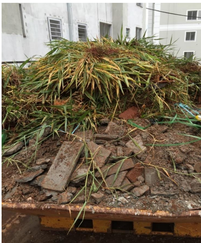
Figura 4: Mistura de resíduos observada na caçamba do CTR nº34
