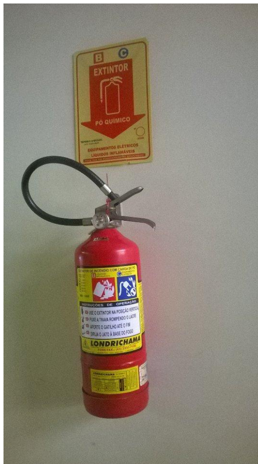
Figura 31: Extintor de incêndio utilizado na Universidade Fonte: Autoria Própria, 2015.
