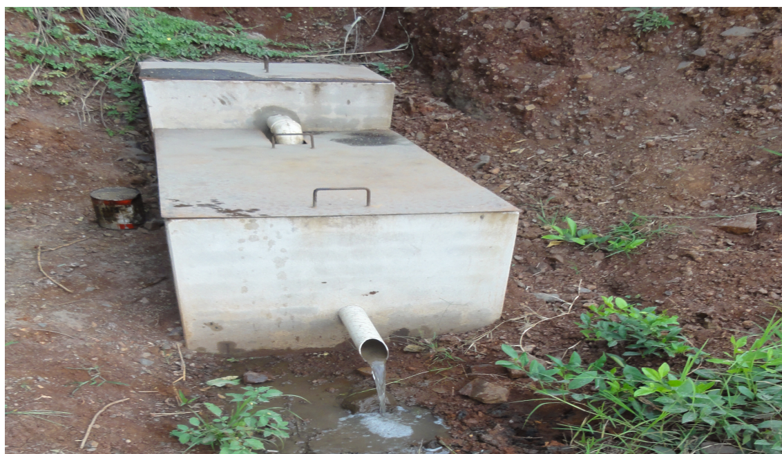
Figura 7.3. Tanque separador de água e óleo.
