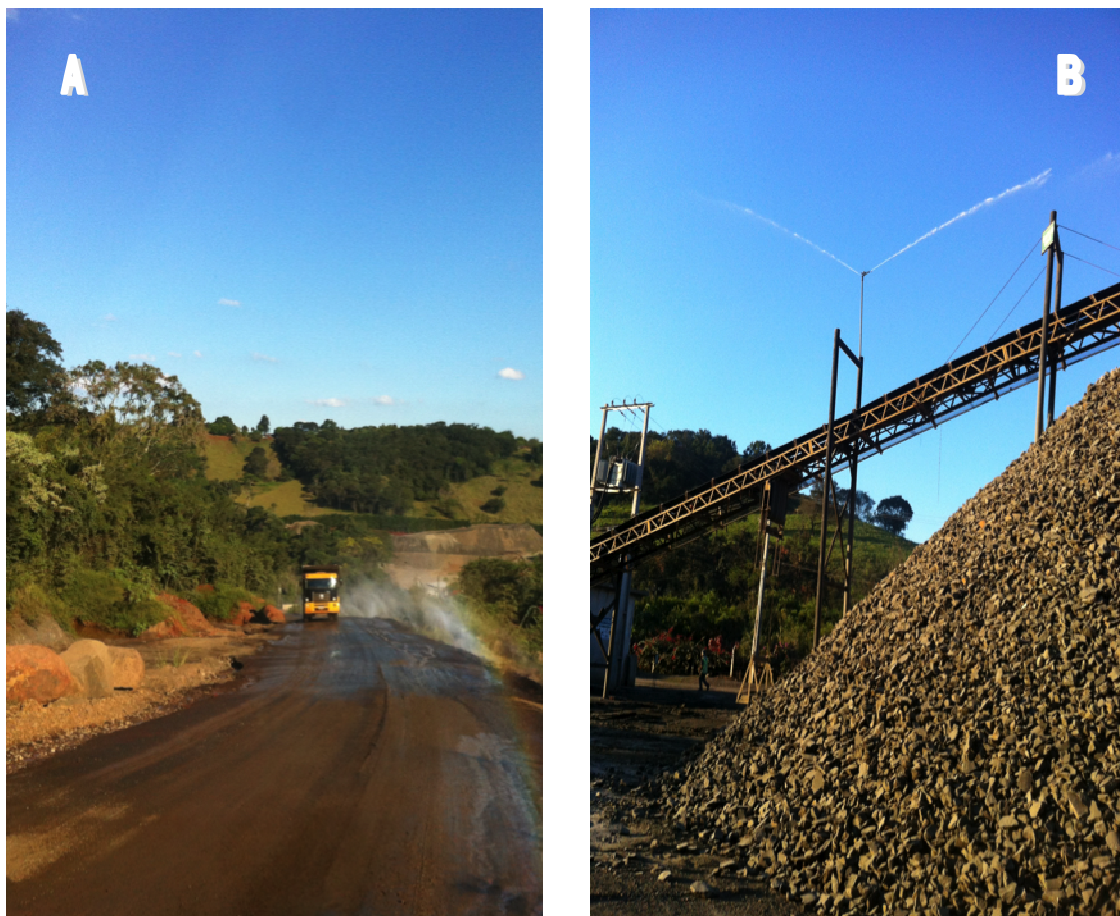
Figura 7.2. Instalação de aspersores: A) Na Estrada de decapeamento e B) No patio de britagem.
