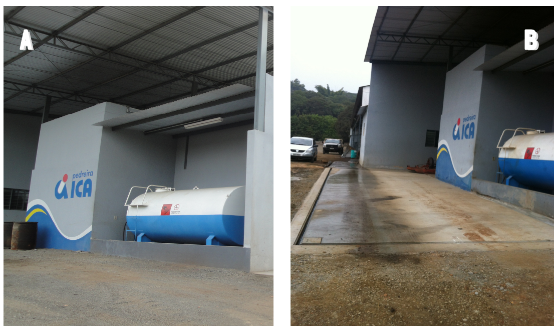
Figura 7.1. Pátio de abastecimento: A) Antes da construção da bacia de contenção e B) Depois da construção da bacia de contenção.
