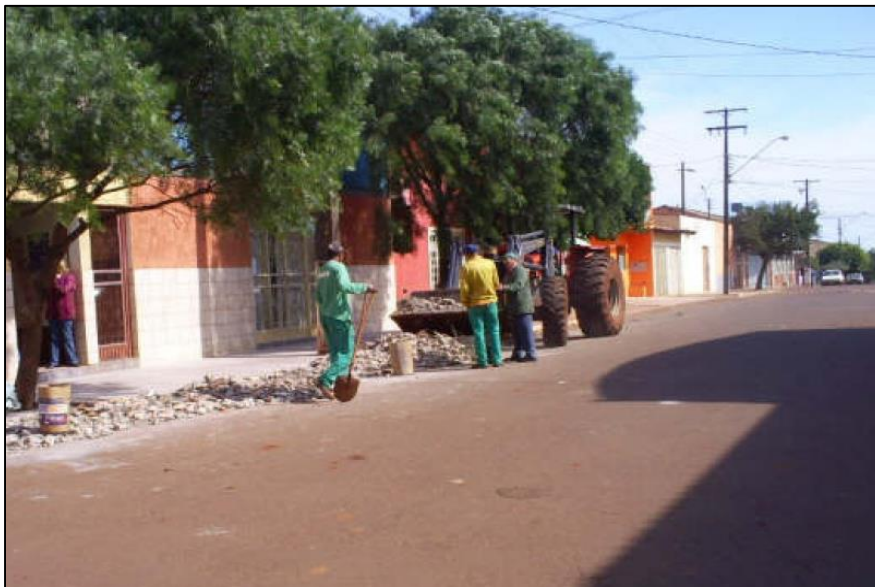
Figura 12 - Pá carregadeira - auxílio na coleta dos resíduos de limpeza pública. Fonte: Plano de Gerenciamento Integrado de Resíduos Sólidos de Nova Santa Bárbara (2009).
