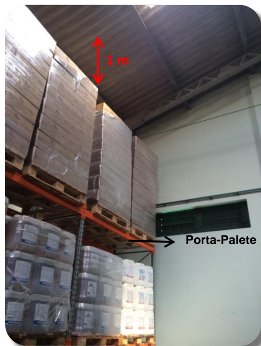
Figura 6 - Distância mínima de 0,5 metros da parede. Fonte: Próprio Autor.
