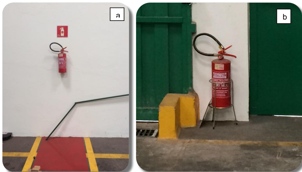
a) Extintor com acesso livre e sinalização b) Extintor sem sinalização
